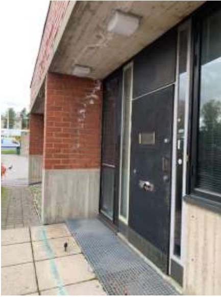
Kuva 87: Siiven sisäänkäynneissä nähtävissä kulumaa
