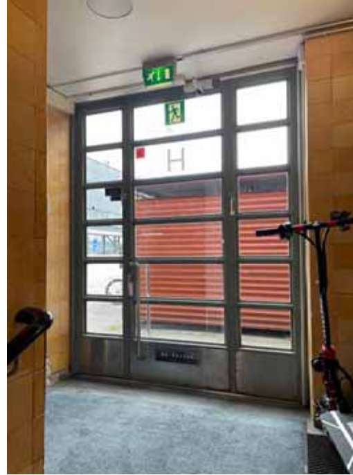
Kuva 61. Porrashuoneissa ulko-ovet on uusittu v. 1993.
