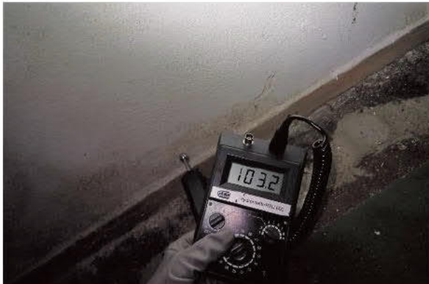
Kuva 54. Tasoitepinnassa on selkeitä pinnoite ja mikrobivaurioita sekä korkeita lukemia pintakosteudenosoittimella.
