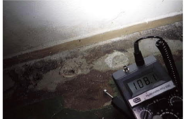
Kuva 53. Betonipinnassa havaittiin korkeita lukemia pintakosteudenosoittimella.
