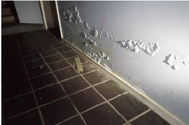
Kuva 4. Tiilirunkoiset väliseinät ovat kärsineet pitkäaikaisesta alhaalta päin nousevasta kosteusrasituksesta ja ovat edelleen tästä johtuen vaurioituneet.
