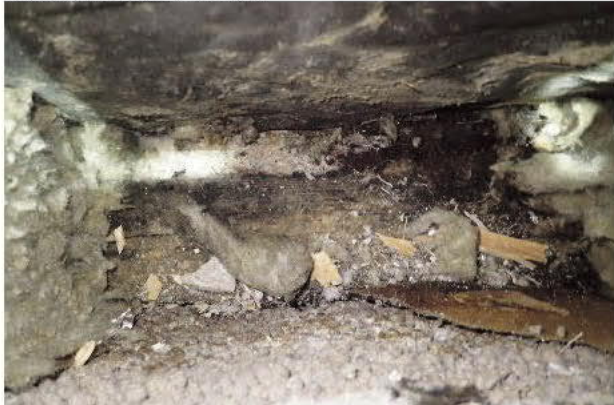
Kuva 17. Kuvaa alaspäin, alajuoksupuuh on aistinva-raisesti arvioituna vaurioitunut.
