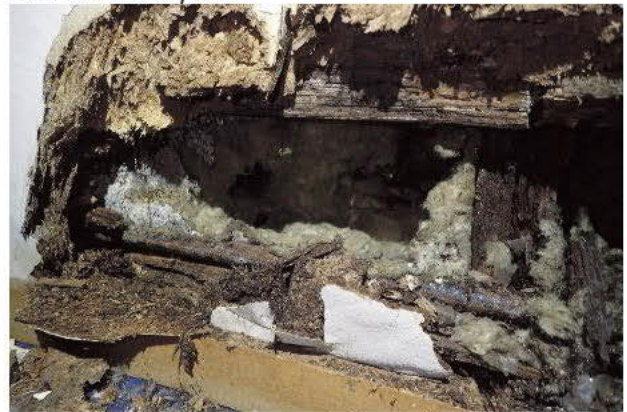
Kuva 30. Rakenne on aistinvaraisesti arvioituna vaurioitunut.
