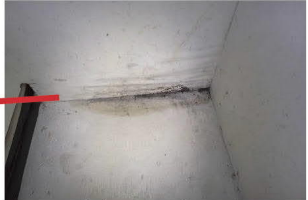
Kuva 56. Väliseinää vasten olevassa komeron takaseinän alareunassa havaittiin mustaa mikrobikasvustoa.
