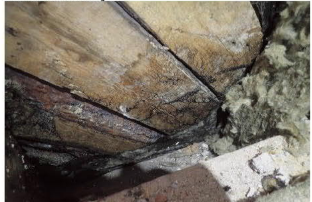
Kuva 24. Vinolaudoitus on aistinvaraisesti arvioituna vaurioitunut.
