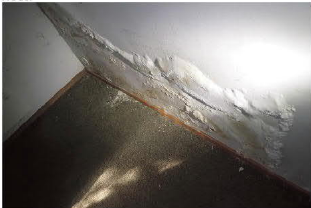
Kuva 6. Tiilirunkoiset väliseinät ovat kärsineet pitkäaikaisesta alhaalta päin nousevasta kosteusrasituksesta ja ovat edelleen tästä johtuen vaurioituneet.
