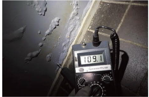
Kuva 36. Tasoitepinnassa on selkeitä pinnoite ja mikrobivaurioita sekä korkeita lukemia pintakosteudenosoittimella.
