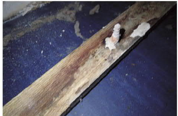
Kuva 34. Jalkalista on aistinvaraisesti arvioituna vaurioitunut.
