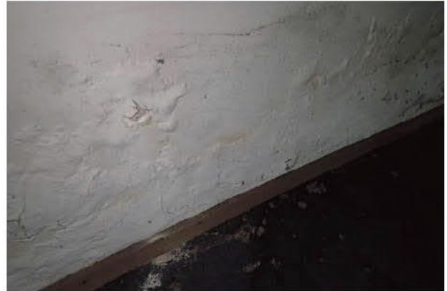
Kuva 32. Tasoitepinnassa on selkeitä pinnoite ja mikrobivaurioita.
