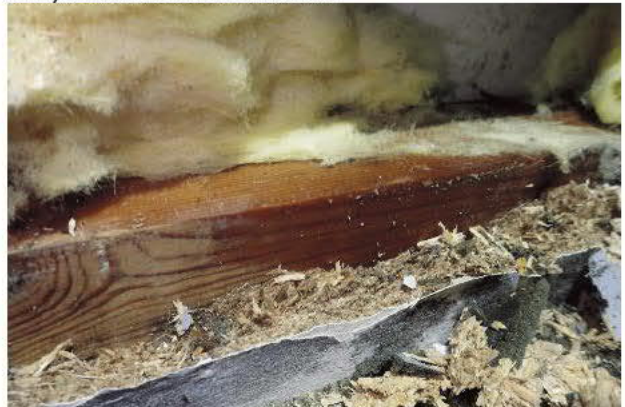
Kuva 51. 2*2 koolauksen alajuoksu on vesimärkä, tämä johtuu todennäköisesti viereisessä avauksessa (RA8) havaitusta putkivuodosta.
