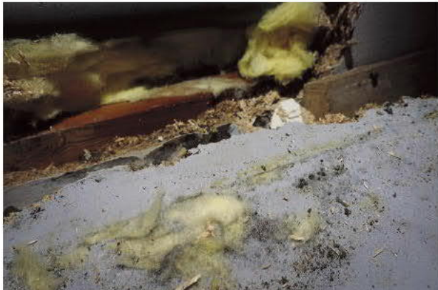
Kuva 50. Sisäverhouslevyn ulkopinnassa on näkyvää mikrobikasvustoa.
