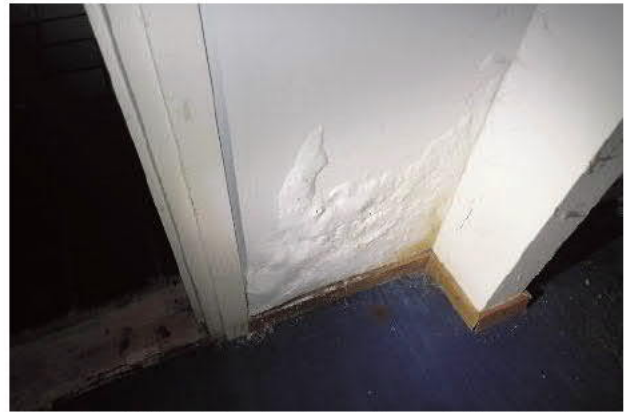
Kuva 3. Tiilirunkoiset väliseinät ovat kärsineet pitkäaikaisesta alhaalta päin nousevasta kosteusrasituksesta ja ovat edelleen tästä johtuen vaurioituneet.
