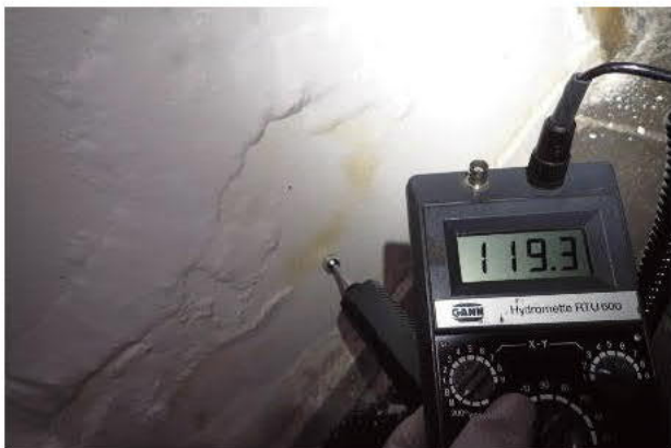
Kuva 37. Tasoitepinnassa on selkeitä pinnoite ja mikrobivaurioita sekä korkeita lukemia pintakosteudenosoittimella.
