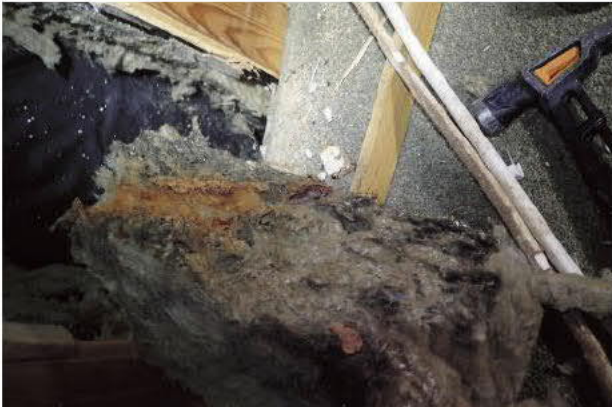
Kuva 23. Villaeristeen alajuoksua vasten oleva alapinta on aistinvaraisesti arvioituna vaurioitunut.
