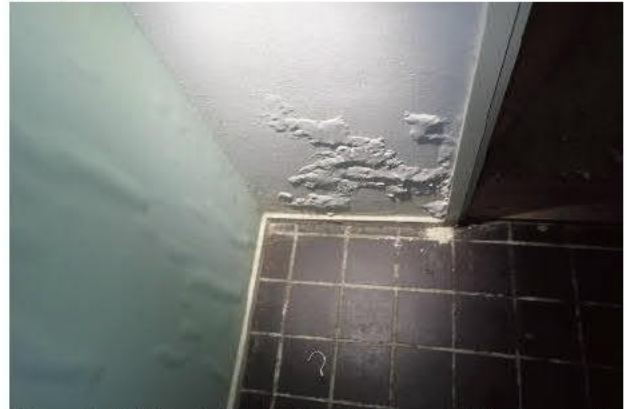
Kuva 5. Tiilirunkoiset väliseinät ovat kärsineet pitkäaikaisesta alhaalta päin nousevasta kosteusrasituksesta ja ovat edelleen tästä johtuen vaurioituneet.
