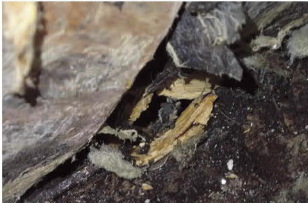
Kuva 19. Alajuoksupuussa on lahovaurioita.
