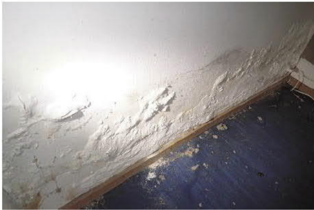
Kuva 2. Tiilirunkoiset väliseinät ovat kärsineet pitkäaikaisesta alhaalta päin nousevasta kosteusrasituksesta ja ovat edelleen tästä johtuen vaurioituneet.
