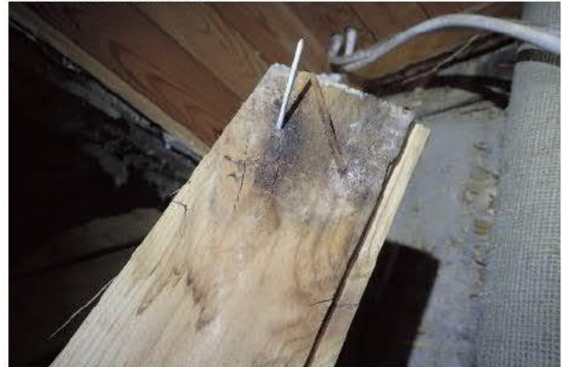
Kuva 26. Ponttilaudoituksen alareuna on aistinvaraisesti arvioituna vaurioitunut.
