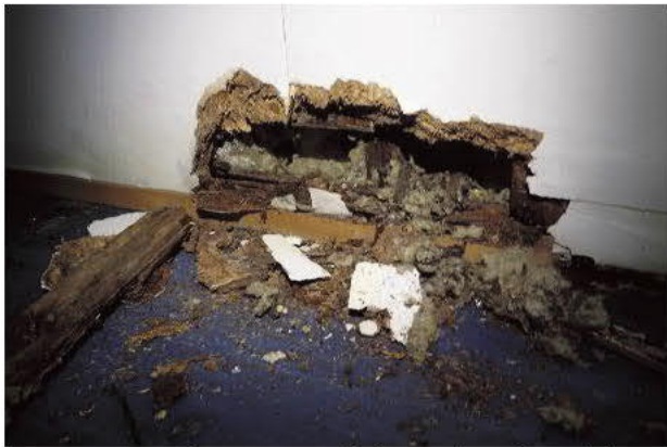
Kuva 29. Rakenne on aistinvaraisesti arvioituna vaurioitunut.
