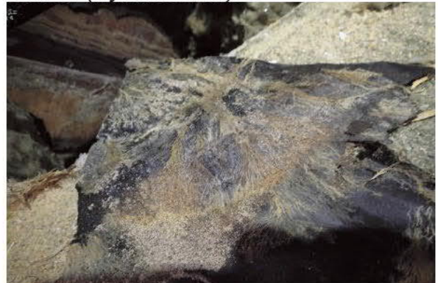
Kuva 20. Vinolaudoitusta vasten olevassa tervapaperissa on runsasta kasvustoa.
