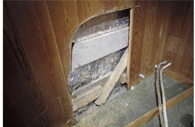
Kuva 22. Rakenne paneelin takana on vastaa kuin avauksissa RA1 ja 2.
