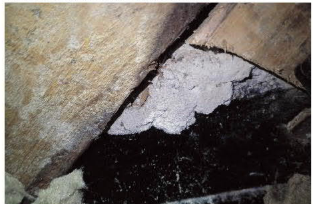
Kuva 14. Ulkopuolen tiiliverhouksen laastipurseet ovat kiinni vinoilaudoituksessa.
