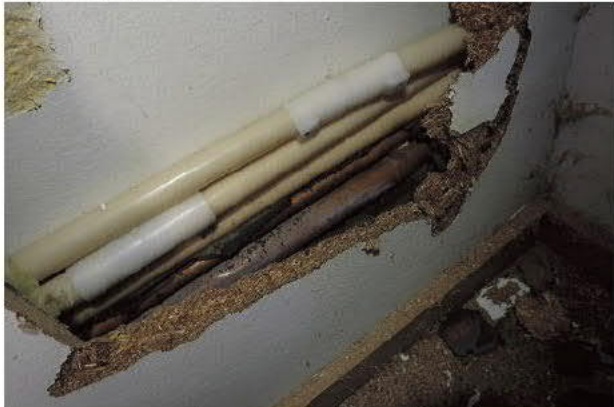
Kuva 44. Lastulevy on märkää, lisäeristys sen alla kulkee putki- ja sähkövetoja.
