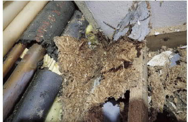
Kuva 45. Lastulevy on märkää ja vaurioitunutta.
