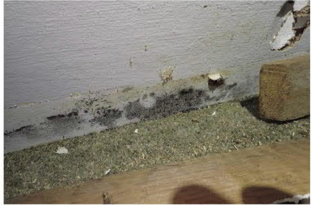
Kuva 49. Sisäverhouslevyssä jalkalistan takana on näkyvää mikrobikasvustoa.
