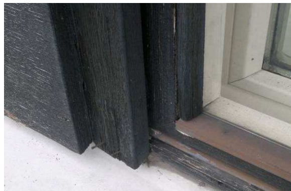
Kuva R-24. Vanha kuva 2. kerroksen ikkunat ovat ravistuneet, kuvassa pohjoisjulkisivun ikkuna.
