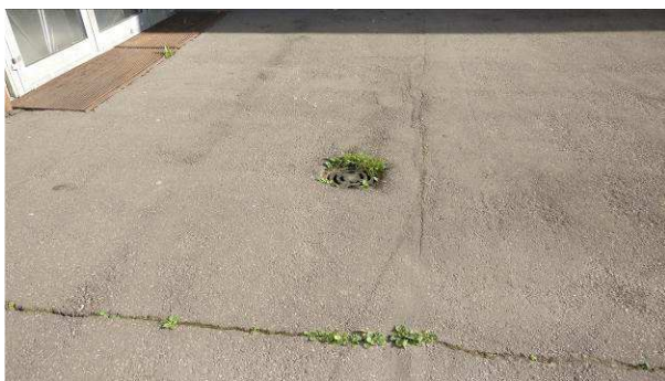
Kuva R-3. Asfaltin vaurioita keskikäytävällä.
