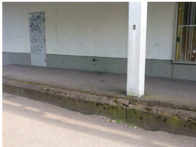
Kuva R-14. Painuma pohjoisjulkisivulla.
