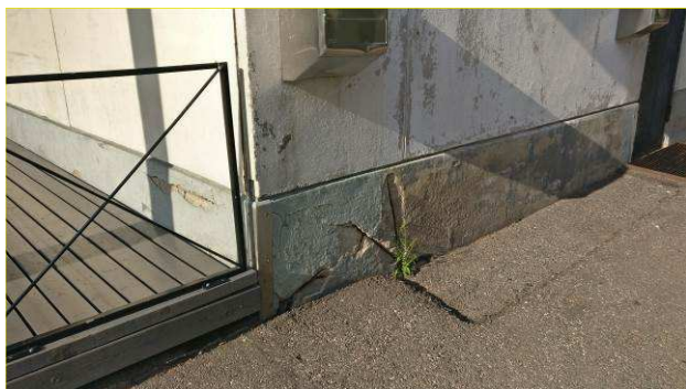
Kuva R-11. Sokkelissa on terästen korroosiosta aiheutuneita vaurioita.
