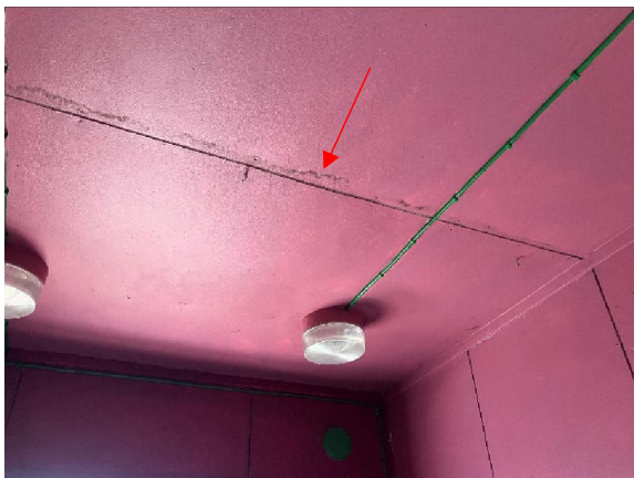
Katon lastulevyverhoilussa havaittiin kosteusjälkiä.
