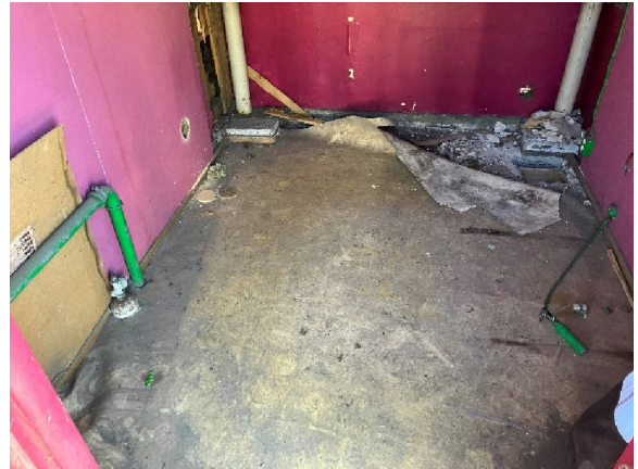
Yleiskuva kioskin sisältä. Lattian muovimatto on osin rikki. Muovimattoa ei ole liimattu lattiaan.
