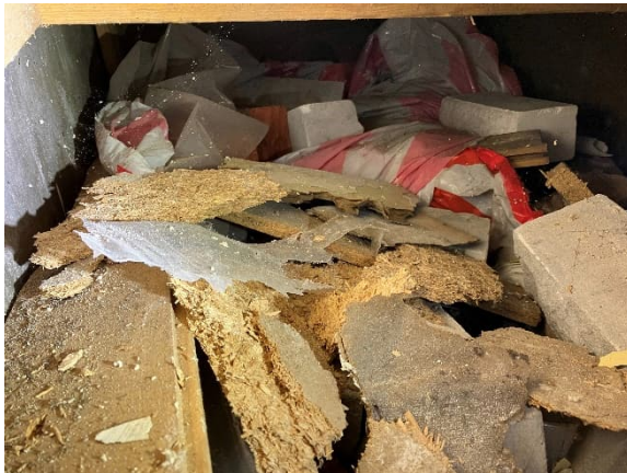
Kioskin lattian syvennyksessä havaittiin runsaasti rakennusjätettä.
