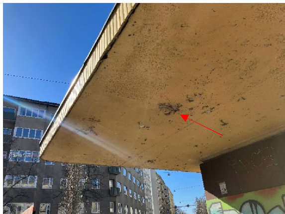
Räystäiden ja lipan alapinnassa havaittiin kovalevy. Kovalevyn maalit hilseilevät.
