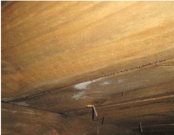
Yläpohjan puurakenteissa on arviolta kosteuden aiheuttamaa tummentumaa.
