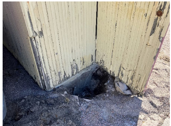
Julkisivujen alaosien puupanelointien maalit hilseilevät. Alaosissa havaittiin lahovaurioita ja haristumista.
