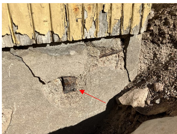
Betoniperustuksissa havaittiin halkeilua ja terästen korroosiovaurioita.
