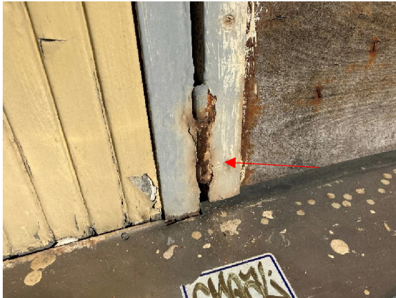
Ikkuna-aukkojen teräsrakenteissa havaittiin korroosiovaurioita.
