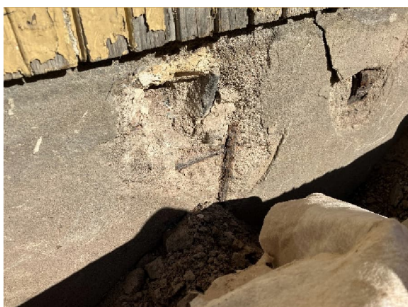
Betoniperustuksissa havaittiin halkeilua ja terästen korroosiovaurioita.
