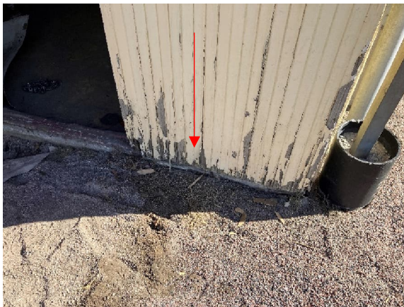
Julkisivujen alaosien puupanelointien maalit hilseilevät. Alaosissa havaittiin lahovaurioita ja haristumista.
