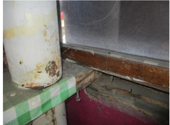
Tiskin kohdalla teräspilarissa ja sisäpuolisissa puurakenteissa on kosteuden aiheuttamia vaurioita.
