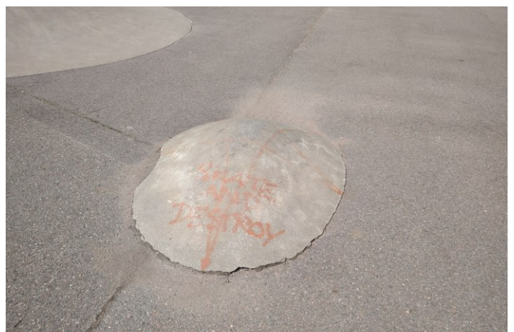
Kuva 13. Esimerkki betonin ja asfaltin pykältämisestä. Osa skeittipaikkojen pykällyksistä vaativat korjausta turvallisuuden näkökulmasta.
