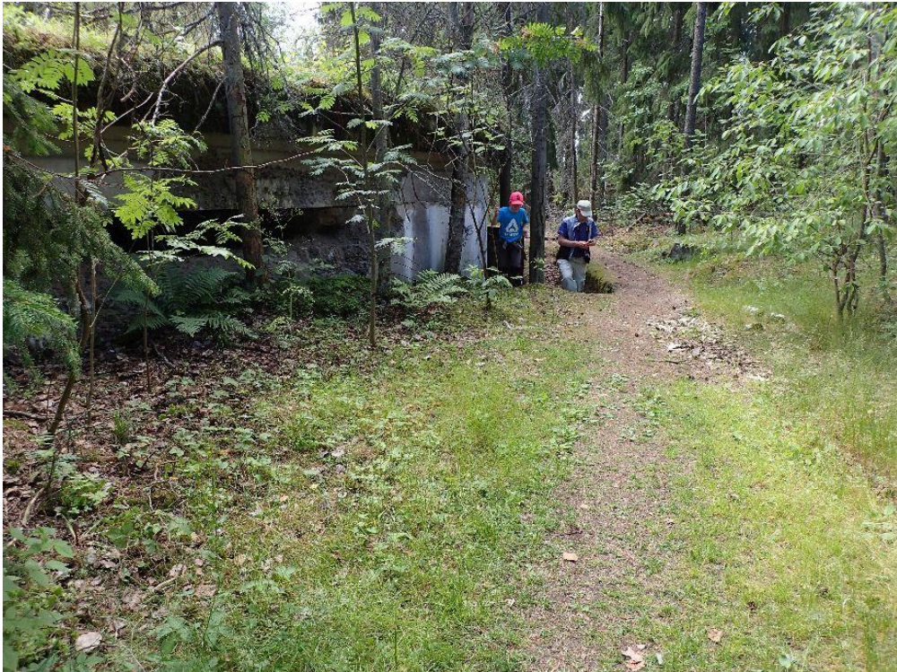
Kuva 23 Puut ja kasvillisuus vaurioittavat tykkipatterin betonirakennelmia. Betonikansi on täysin karikkeen ja matalan kasvillisuuden peittämä.
