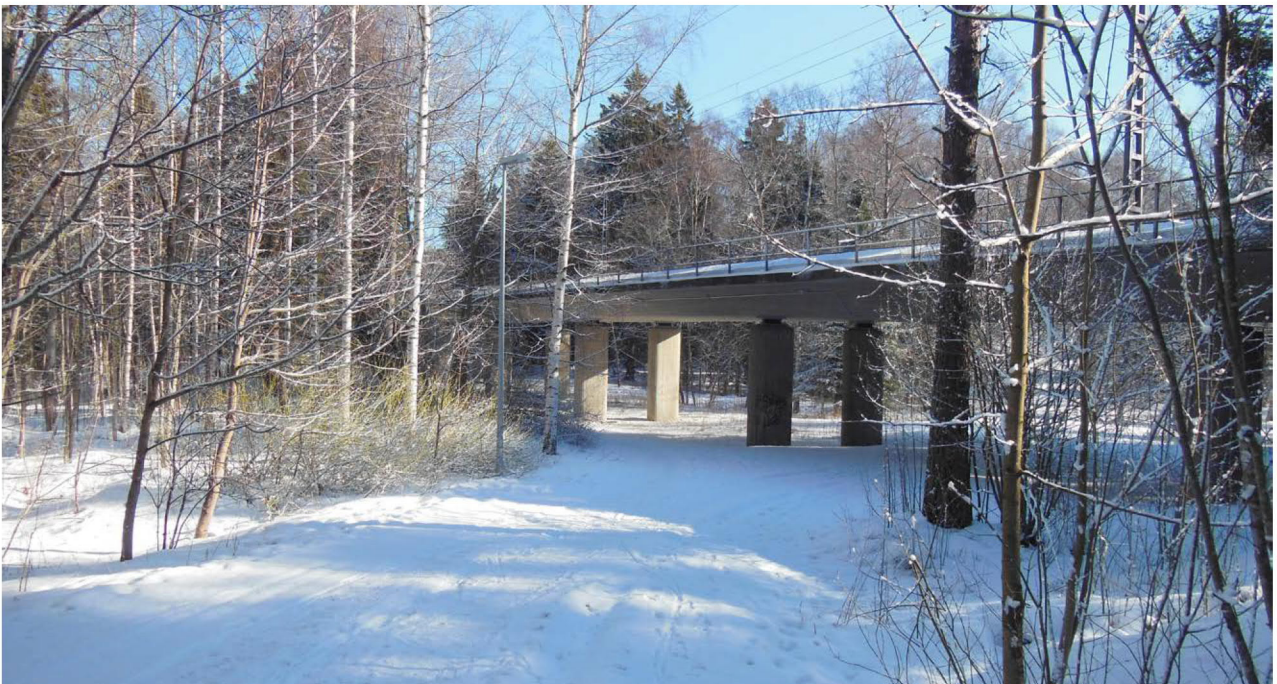
Kuva 35. Runsaan vapaan tilan jättävät siltarakenteet mahdollistavat myös luonnonympäristön jatkumon sillan allitse. Kuvan mukainen ratkaisu on esimerkki ekologisesti hyvin toimivasta ratkaisusta, joka palvelee monen kokoista eläimistöä. Kehärata, Pohjois-Haaga. Kuva: Lauri Erävuori.
