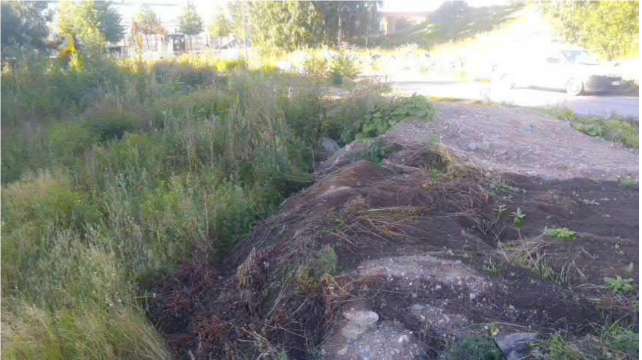
Kuva 3: Yleiskuvaa alueesta, itäosa. Tien vieressä tehty kaivu- tai tasaustöitä. Kuva otettu lounaaseen päin.
