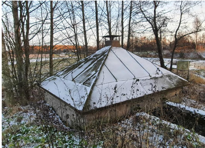
Kuva 12. Pumppuhuone. Kuva Hanna Keskinen / Ramboll Finland
