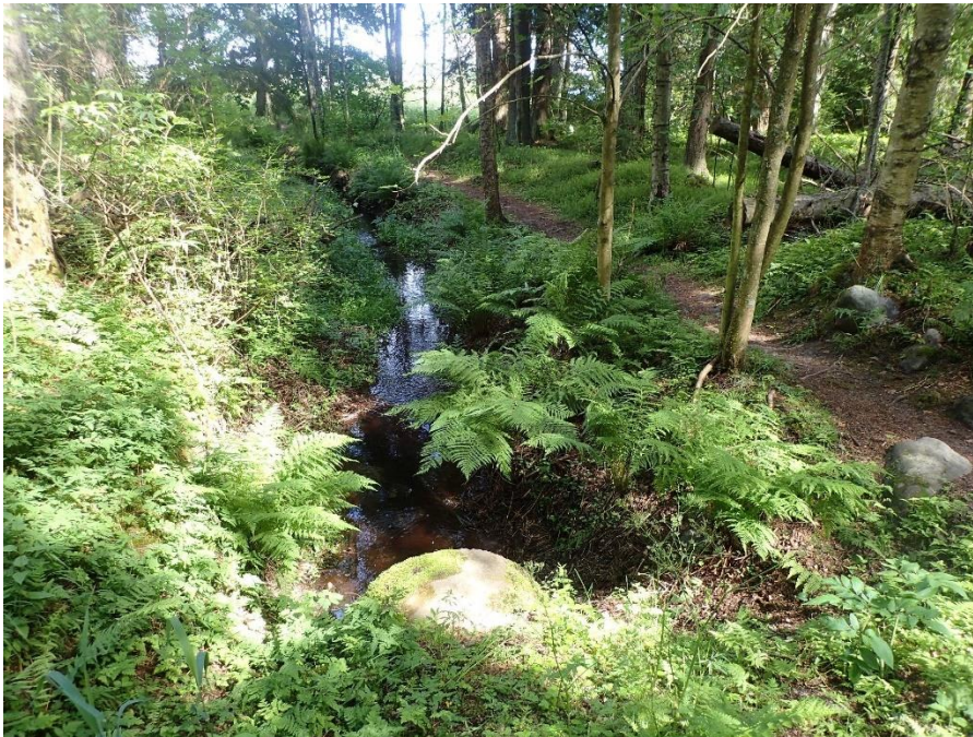
Kuva 32 Ulkoilureitin ylittävän tierummun kuntoa on tarpeen seurata. Se sijaitsee laskuojan alajuoksulla.
