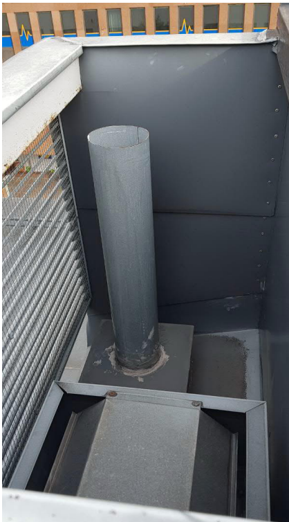
Kuva 5 Jäteilmaputki (NS150) vesikatolla
