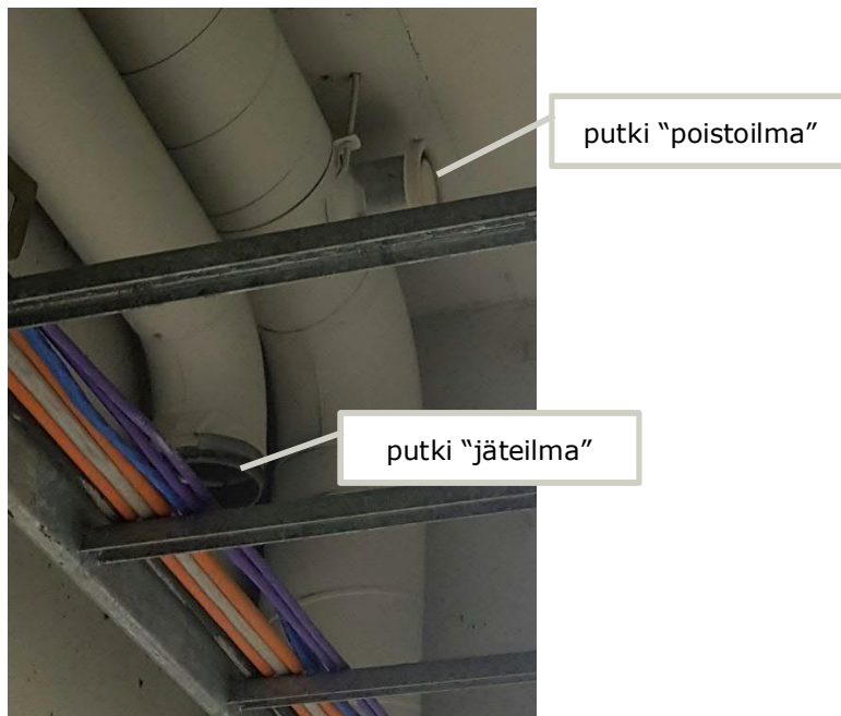
Kuva 4. Varastuhuoneen katossa olevat poistoilmaputket
