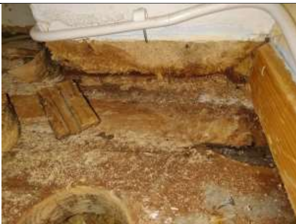
Kuva 5 seinän alaosassa on kosteuden aiheuttamaa vaurioitumista.
