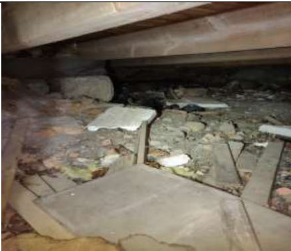
Rakennusjätettä talon alla.
