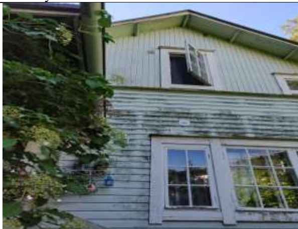
Maalipinnat kuluneet ja mustuneet. Myös ikkunapuitteissa on mustumaa.
