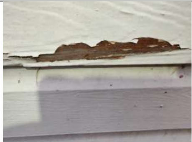
Kuva 20 laudoitus on maalin alla märkä.
