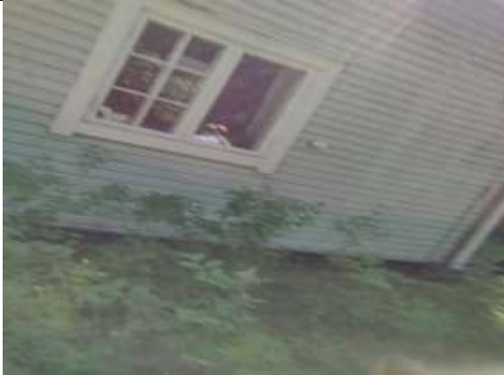
Osa ikkunoista on vaihdettu yksilasisiksi.
