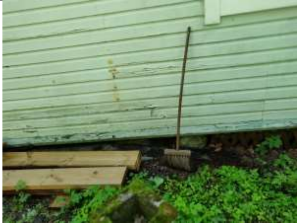
Alaliittymän vesilaudoissa lahovaurioita
