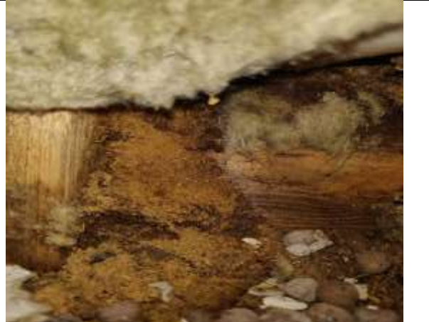
Kuva 12 WC/KPH alla on sahanpuruksi muuttunutta puuainesta ja kevytsoraa.
