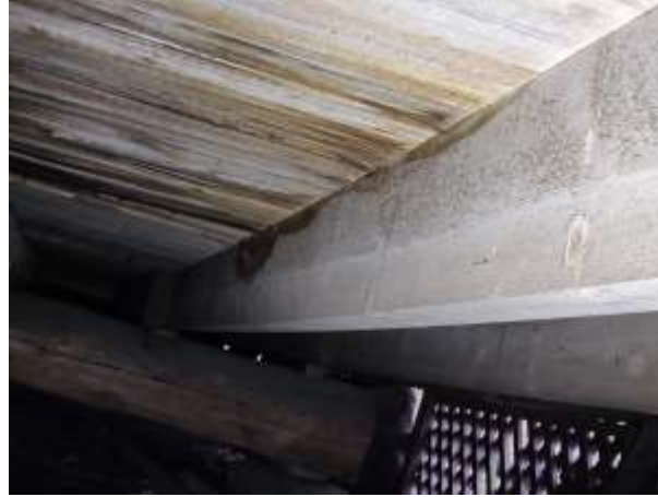
Kuva 10 Kylpyhuoneen alapuolella havaittavissa kosteusjälkiä kylpyhuoneen kohdalla.
