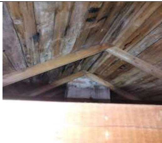
Kattoristikko ja aluslaudoitus. Aluslaudoituksessa vanhoja kosteusjälkiä.
