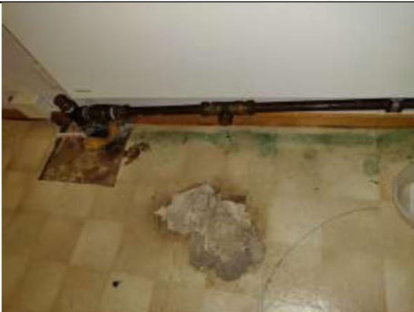
Kylmävesiputki tulee rakennukseen makuuhuoneen lattiasta, eikä sitä ole eristetty rakennuksen alapuolelta, eikä huonetilassa. Kylmä putki kondensoi ja valuttaa vettä koko ajan rakenteisiin.
