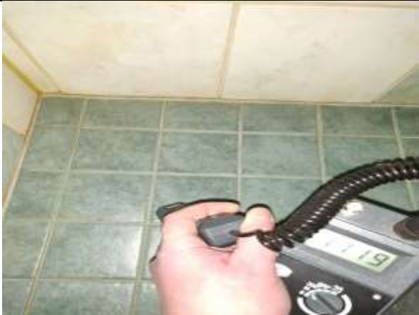
Kuva 9 Kylpyhuoneessa poikkeavia kosteusarvoja, vaikka tiloja ei ole käytetty kuukausiin.
