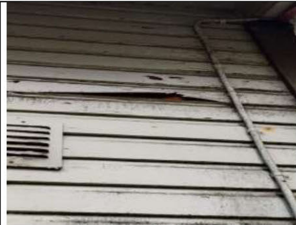
Kuva 19 maalipinta irtoilee seinästä.
