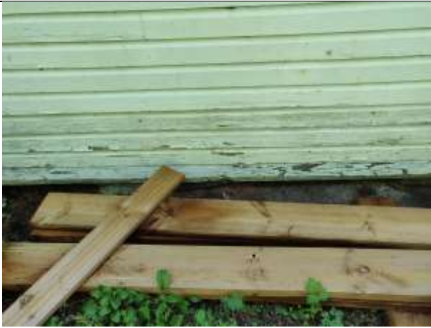
Perustus on maan pinnan tasolla, seinän alaosa on märkä.
