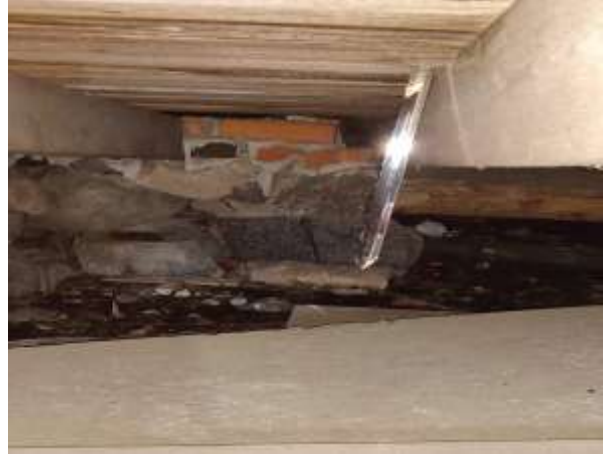
Kuva 8 Kuva rakennuksen alta, villaveitsi laudoituksen välissä.
