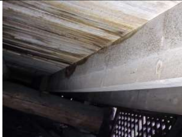
Kuva 10 Kylpyhuoneen alapuolella havaittavissa kosteusjälkiä kylpyhuoneen kohdalla.
