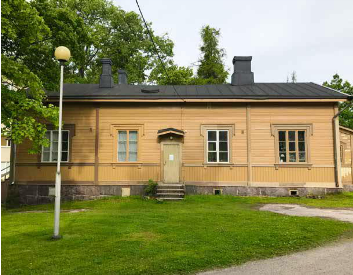
Puusepänerveaan itäjulkisivu maalipinnan uusimistyön ollessa käynnissä. Rakennuksen itäjulkisivuun ei alun perin kuulunut sisäänkäyntiä vaan se lisättiin 1940-luvulla. Mahdollisesti samaan aikaan rakennuksen etelä- ja pohjoisjulkisivun sisäänkäyntejä uudistettiin. HY.
