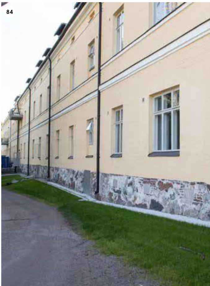
Sairaalan päärakennuksen B-siiven pohjoisjulkisivu. Sen eteen valettiin 2017 betoninen vesikouru ja sokkelista poistettiin rappaus.
