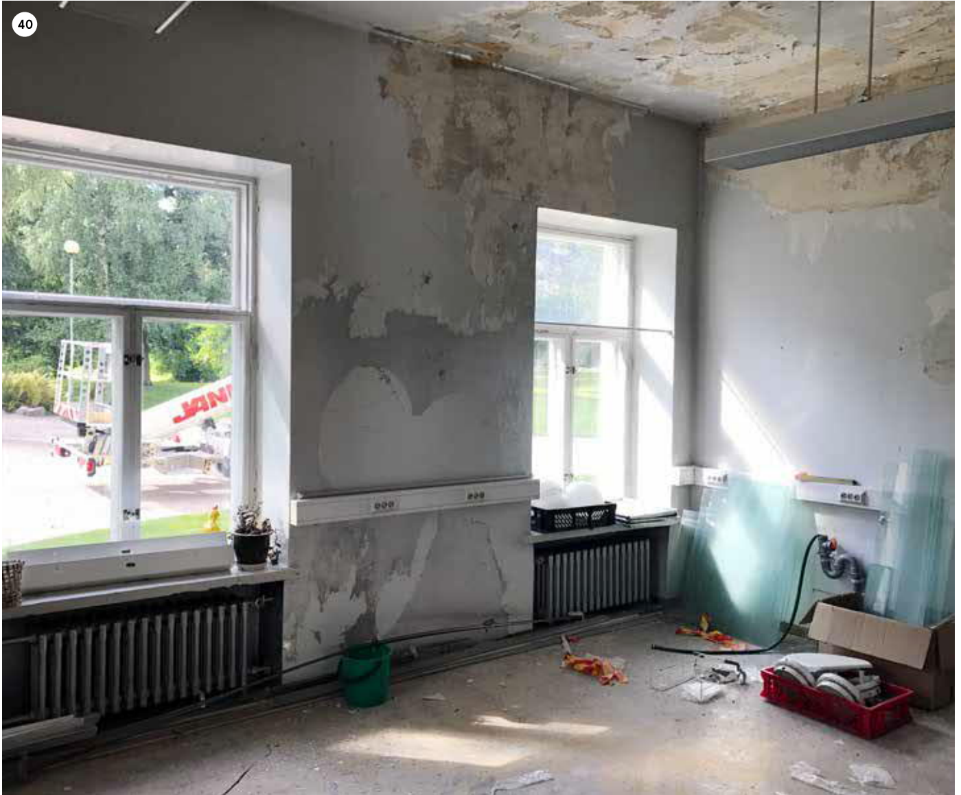
G-osan ensimmäisen kerroksen itäpään huonetilat olivat huonossa kunnossa tilan yläpuolisessa toisessa kerroksessa vuonna 2015 sattuneen vesivahingon takia. Tilat korjattiin kaupungin toimesta 2017. Huoneissa on 1920-luvun T-ikkunat, joiden alimpien ruutujen välissä on välipuite. AS.
