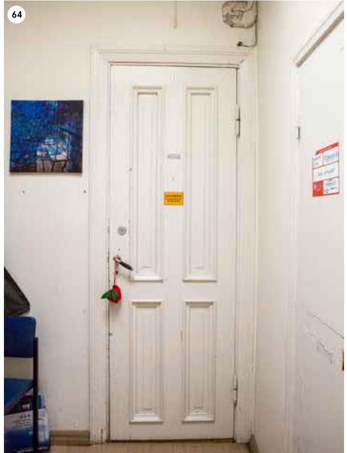
64 C-siiven kolmannen kerroksen huonetiloissa on neljällä peilillä varustetut yksilehtiset ovet. Painike on messinkiä ja siinä on puinen sorvattu osa.
