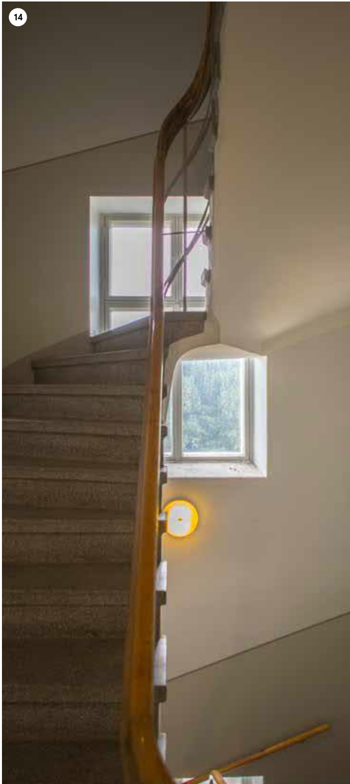
B-siiven länsipään portaikko on rakennettu 1920-luvulla, kun kolmas kerros otettiin kokonaisuudessaan käyttöön. Betonielementeistä koostuva porraskorras sijoitettiin entiseen potilashuoneeseen, peittäen osan ikkunoista.
