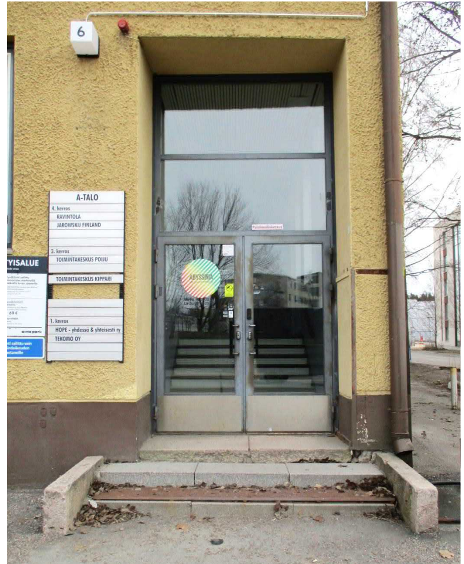
Kuva 42. Pääsisäänkäynti. Ovi on uusittu, ajankohta ei tiedossa.
