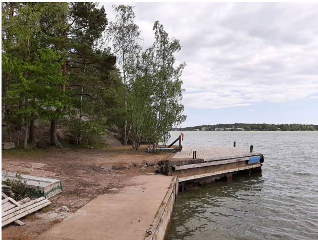
Kuva 25. Vartiosaaren rannan laituri (ulkoneva, puukantinen osuus korjataan vuonna 2024). (Kuva: Sitowise Oy.)
