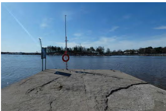
Kuva 103. Vanhan vesiliikennelaiturin betoniarkun kunto on epäselvä.
