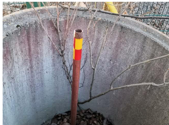
Valokuva 6. Piste 12012/01 putkesta puuttui tulppa ja se oli tukossa.
