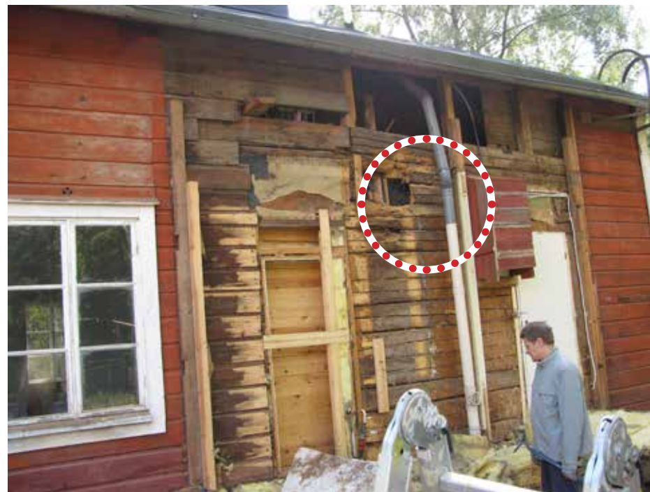
kuva 4: Hirsirungossa oleva lahovaurio sijoittuu kuva 2:n mukaisen vanhan ulokkeen katon sisäjiiriin.
