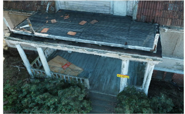
Parvekkeen kaiteet romahtaneet, parvekkeella pudonneita kattotiiliä (Dronen pistipilvikuva)
