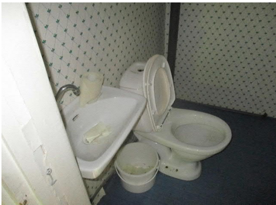
Päärakennuksen vesikalusteita, ovat vesipaineettomia sekä osin purettuja.
