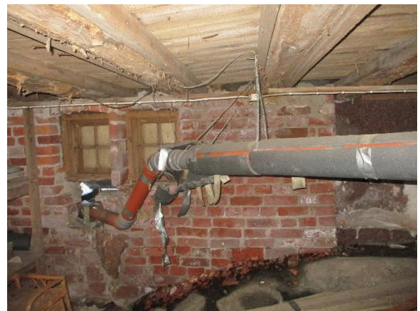
Muoviviemäritä alapohjassa, joissa kannakoinnit ovat reikänauhaa pelkästään nauloissa roikkumassa. Eristys osin puuttuu
