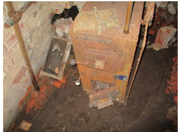
Alustatilassa vanhassa kattilahuoneessa on todella vanha ja aikanaan lämmityskäytöstä hylätty keskuslämmityskattila, joka on metalliro-mua.
