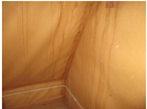
Toisen kerroksen komeroissa vesien valumajälkiä, ulkoseinänä toimii alempi vesikattolape, komerot vuorattu rakennuspahvilla
