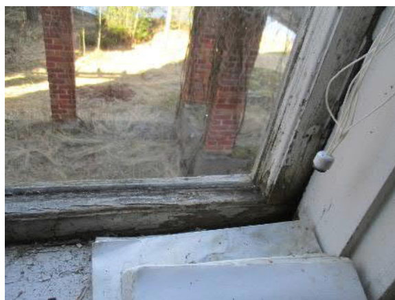
Ulkopuitteen kunto monin paikoin heikko
