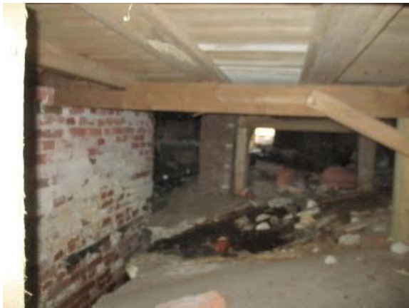
Ryömintätilan pohjalla paikoin vettä
