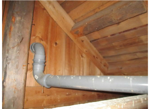
Päärakennuksen yläpohjatilassa kattoristikon päällä on pitkää vaakasuora osuutta eristämättöä tuuletusviemäriä, menee päädystä ulos
