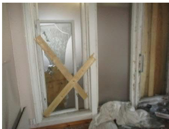
Ilkivallan johdosta ikkuna rikottu ja lattialla roskaa
