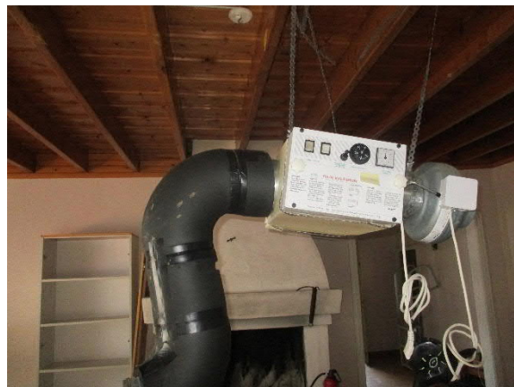
Tilapäinen asennus kiertoilmalämmittimelle, ei ollut toiminnassa
