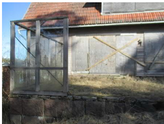
Ikkunat on vaneroitu umpeen rakennukseen kohdistuneen ilkivallan vuoksi
