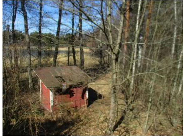
Ulkovarasto osin romahtanut
