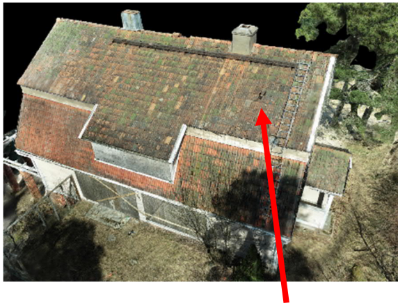
Yleiskuva etelän puoleisista lappeista (Dronen pistepilvikuva), rikkoontuneita tiiliä
