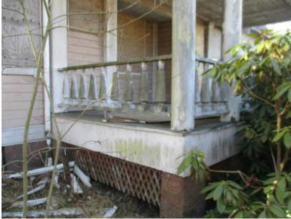
Etupihan terassin puuosissa maalivaurioita ja kulumaa
