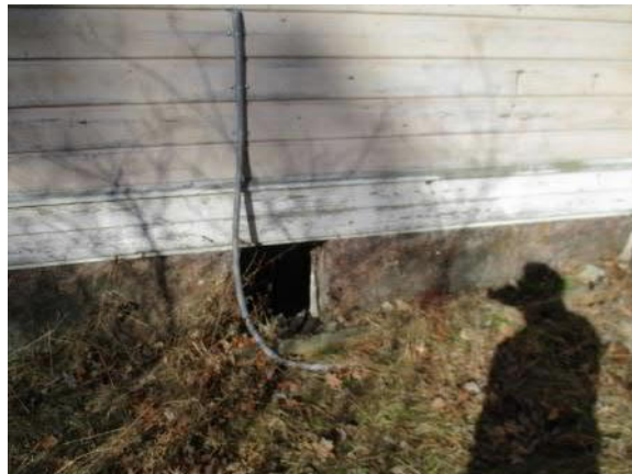
Tuuletusaukko lähellä maanpintaa, maanpinta kallistaa paikoin rakennukseen päin
