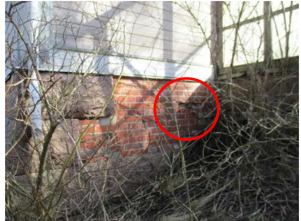
Sokkelin tiilimuurauksessa paikoin vaurioita
