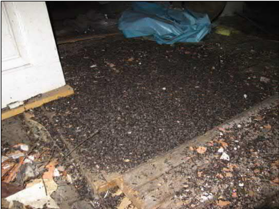
LIITEKUVA 1. Degerön kartanon ullakolla havaittu lepakoiden papanakerros, noin 3 cm paksu. Rakennus on lepakoiden lisääntymi-/levähdyspaikka.
