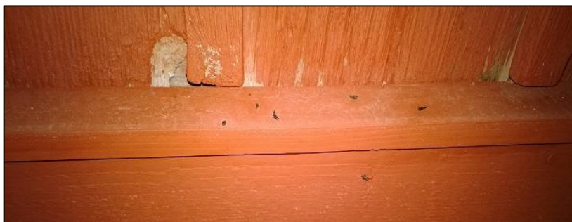
Kuva 7. Lepakon ulostetta Kaivoshuvilan seinälaudoituksen alapuolella.
