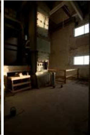
Kuvat 6.46-6.48 (vasemmalla) Konetornin 7.-8. kerrokseen sijoittuu toinen rakennuksen viljan kuivauslaitteista. Valokuvat Talli / MN.
