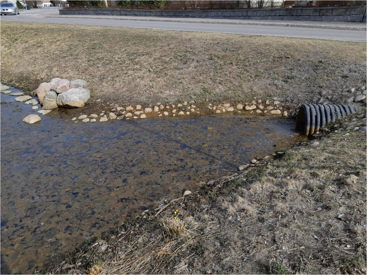
Kuva 8. Kaitalahden tulva-altaan poistoputken suussa on runsaasti lietettä tai levää.
