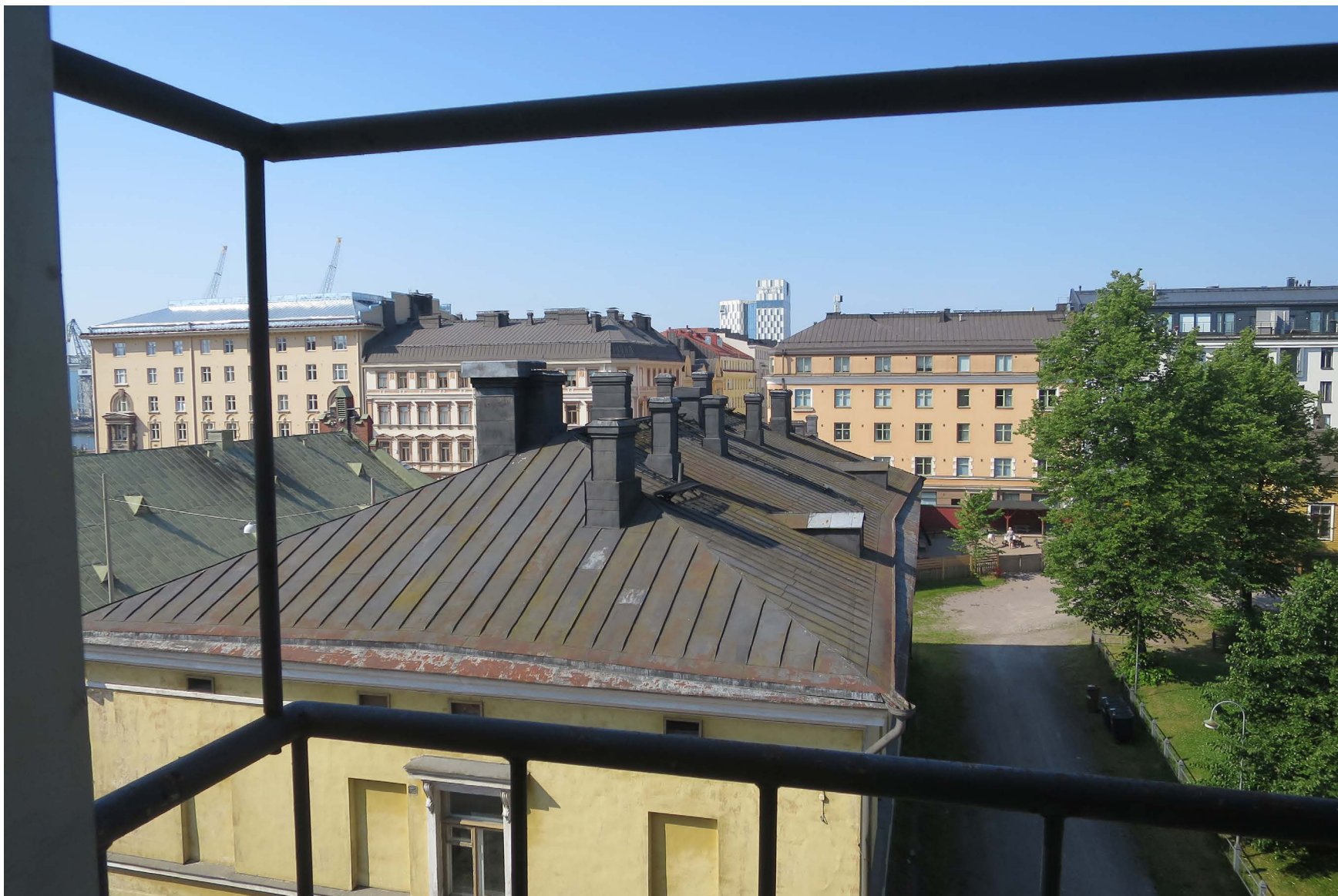
Nykyinen vesikate on konesaumattua peltiä, perinteisen malliset piiput ja uudet piippurakenteet on pellitetty.
