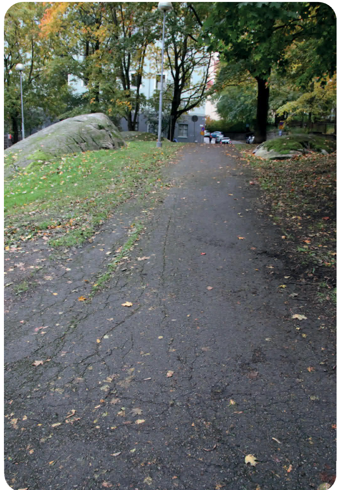
Kuva 64. Franzénin puistikon itäosan käytävät ovat päässeet huonoon kuntoon.
