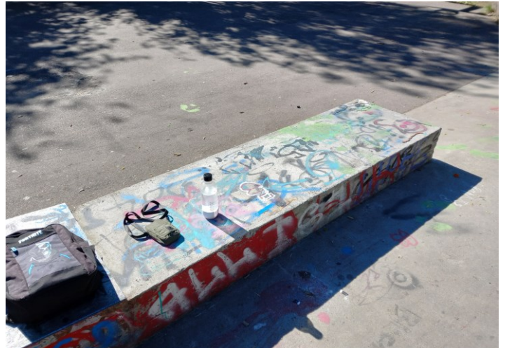
Kuva 11. Skeittivälineestä on irronnut kokonainen kivi-levy.
