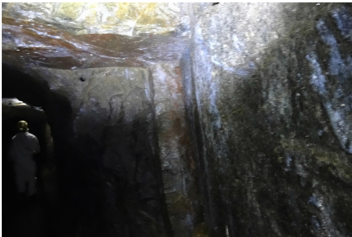
Kuva 9. Kuva paaluväliltä 1280-1150, jossa näkyy tunnelin seinämällä itä-länsi suunnassa kulkevia pystyasentoisia rakoja, sekä vaaka-asentoisia rakoja tunnelin katossa. Kuva laskevan paaluluvun suuntaan.
