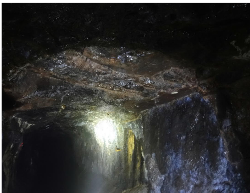
Kuva 15. Kuva paaluväliltä 1035 -800. Kuvassa näkyy tunnelin kollisseinällä pystyasentoisia koilliseen kaatuvia rakoja ( 90^{\circ}/020^{\circ} ), sekä vaaka-asentoisia rakoja tunnelin katossa. Kuva laskevan paaluluvun suuntaan.
