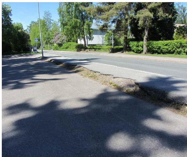
Koulun pysäköintialueen ja jalkakäytävän välinen luiska on sortunut.
