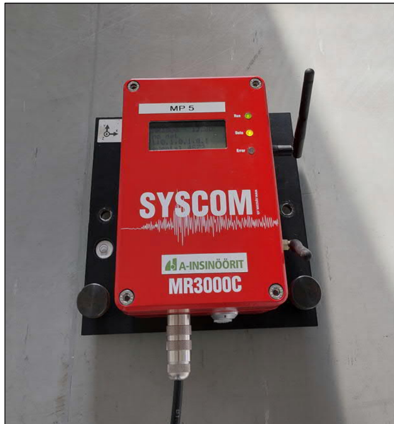
Kuva 5.3. Värähtelymittarin asennus lattialle.
