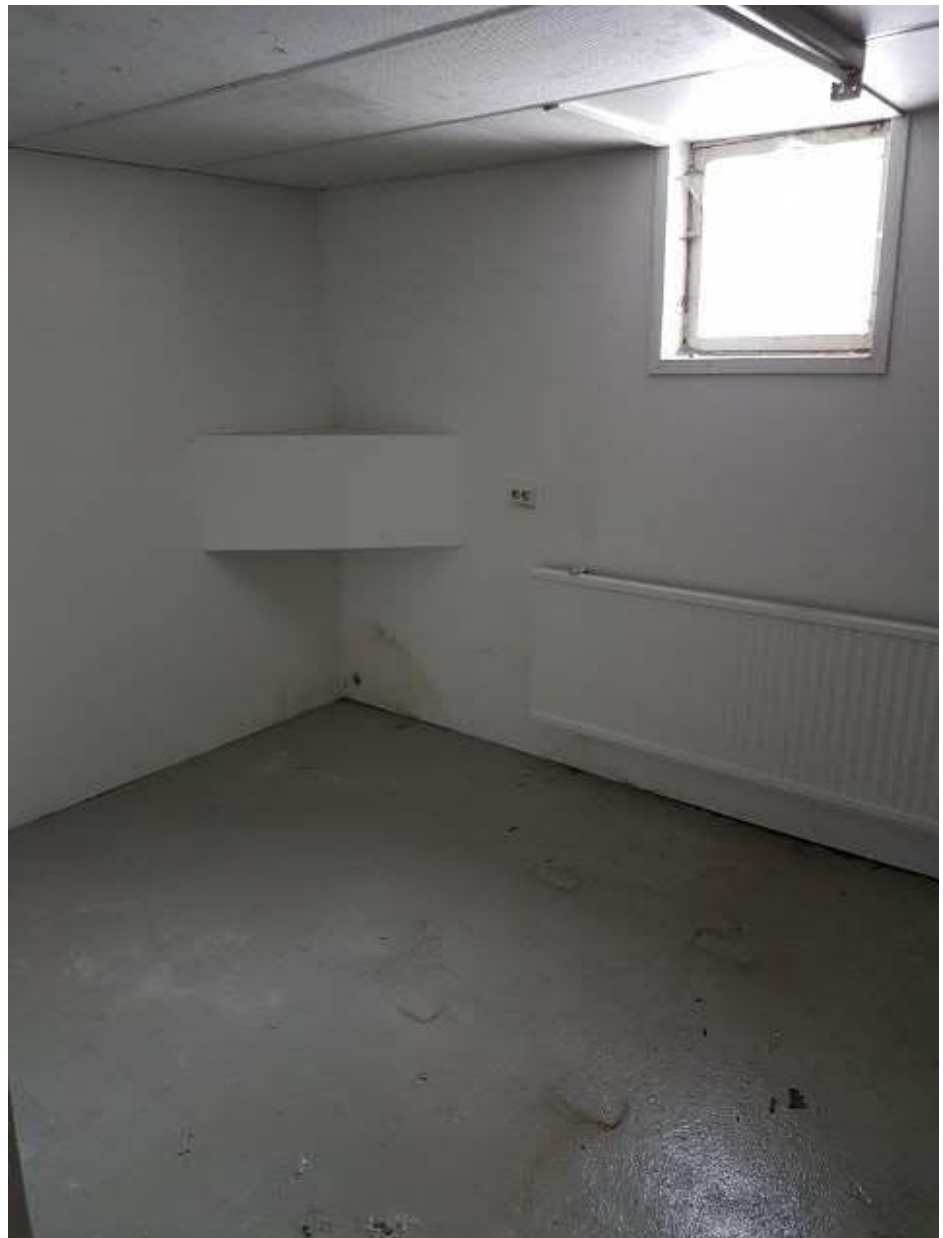
Kellarin katto on matalalla, seinissä näkyy kosteusvaurioita, helmikuu 2017.
