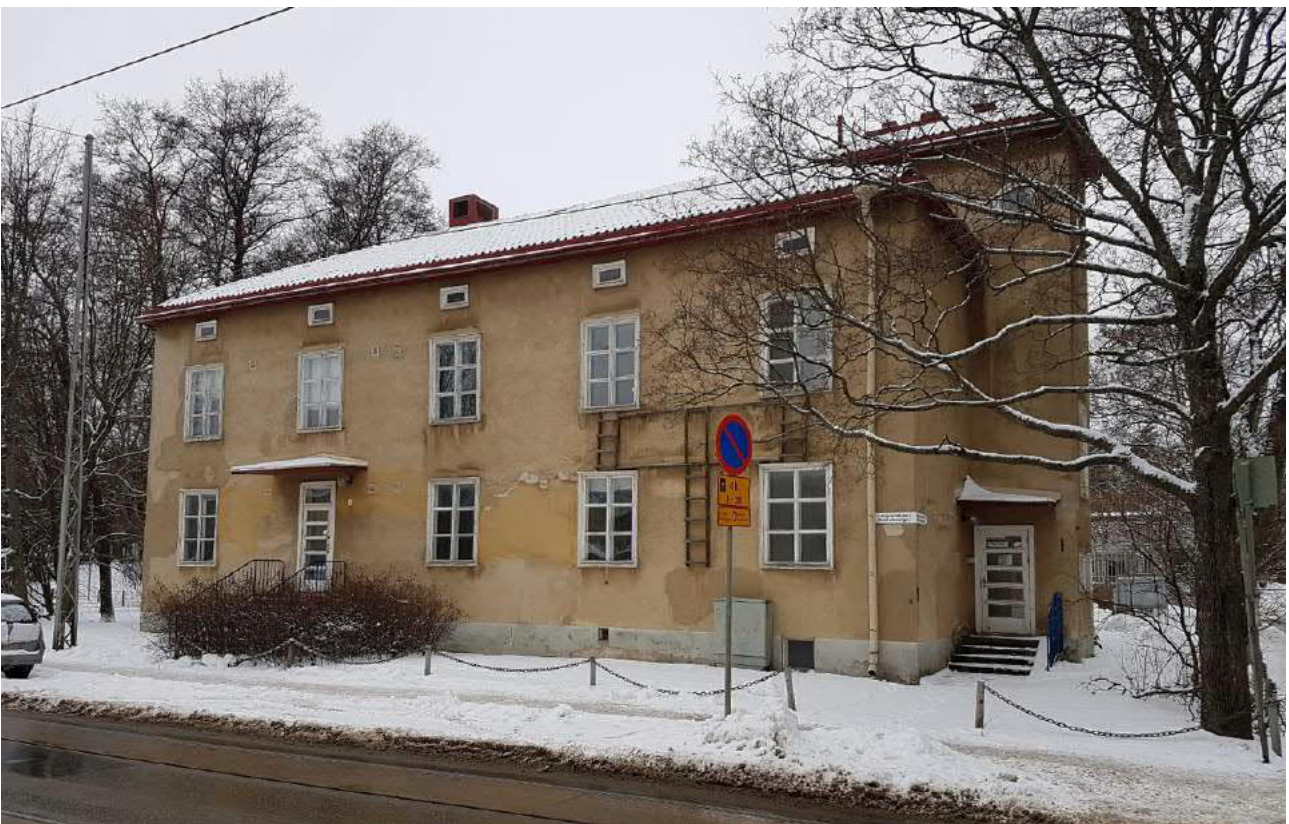
Julkisivu Laajalahdentielle, helmikuu 2017. Julkisivurappaus on kulunut ja rapautunut.
