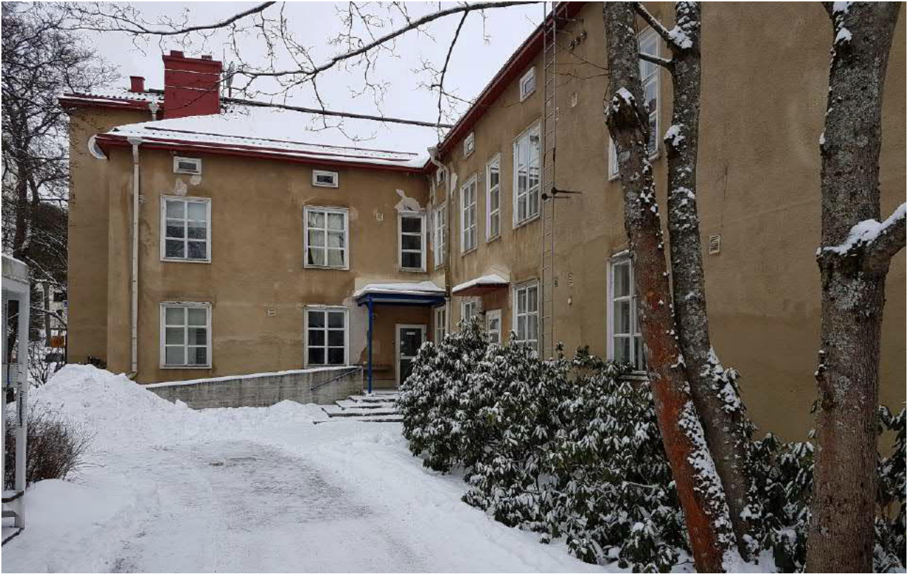
Julkisivut koilliseen ja luoteeseen, helmikuu 2017. Sisänurkan katoksen tienoilla rappaus on kaikkein huonoimmassa kunnossa.
