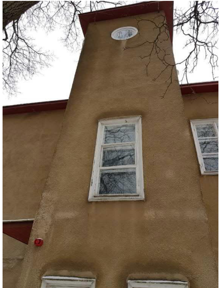
Koillispään porrashuone, helmikuu 2017. Kulunutta rappausta, tornimaisen porrashuoneen yläosassa on nähtävissä 1920- ja -30 -lukujen taitteelle tunnuksenomainen pyöreä ikkuna.
