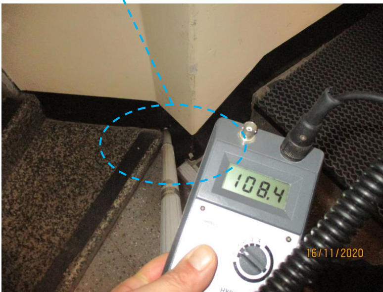
Seinien alareunoissa kohonneita pintakosteusarvoja
