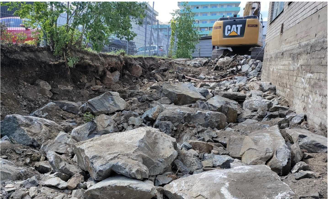
Kuva 4. Tontin kaakkoisnurkan kaivanto. PAH-yhdisteiden takia kaivantoa syvennettiin. Vasemmalla sivulla metalliromua sisältävä seinämä (N47).
