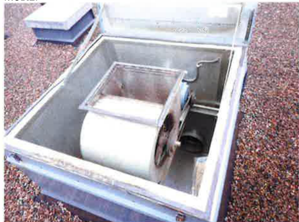
Yleiskuva huoneistoja palvelevasta yhteiskanavapuhaltimesta.
