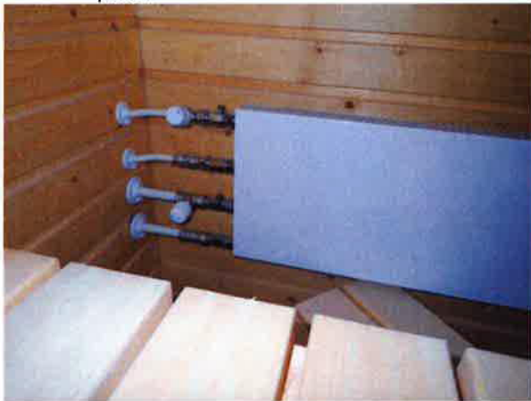
Yleiskuva saunan lämmityspatterista.
