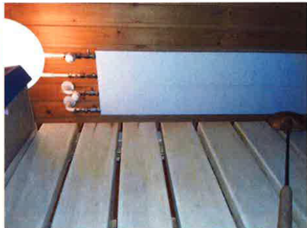
Asunnon saunan lämmitys- ja kiertovesipatteri.
