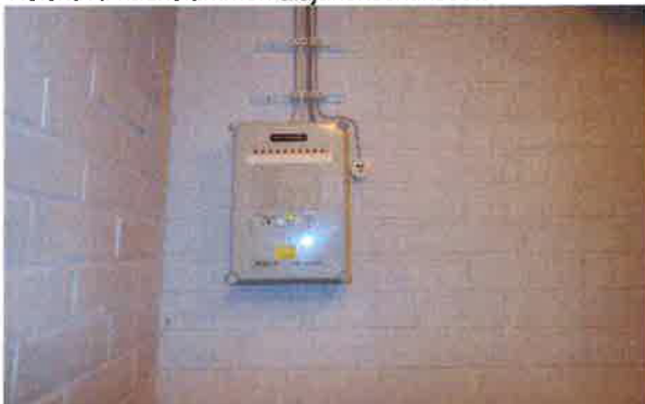
LVI- hälytyskeskus lämmönjakuhuoneessa.
