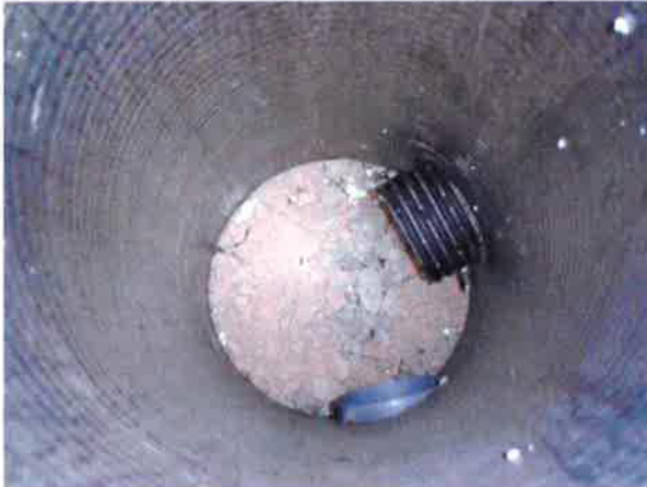
Yleiskuva salaojan tarkastuskaivosta.
