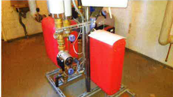
Yleiskuva kaukolämmön alajakokeskuksesta.
