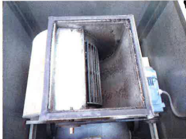
Yleiskuva huoneistoja palvelevasta yhteiskanavapuhaltimesta.
