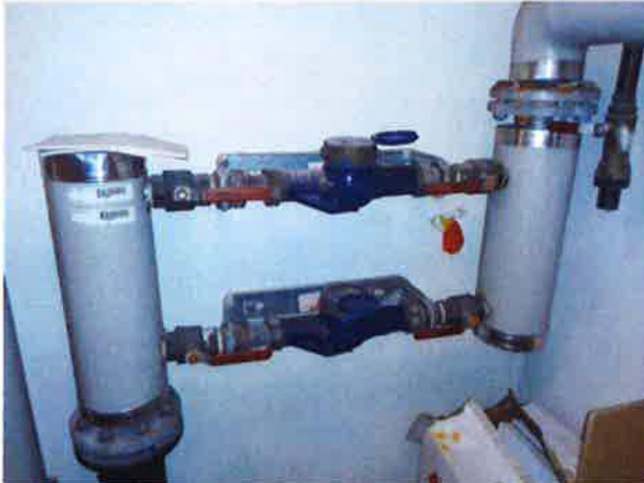
Kiinteistön vesimittari lämmönjakohuoneessa.
