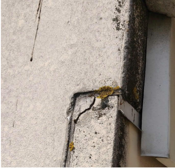
Kuva 5. Paikoittain julkisivuelementtien sammaloitumista havaittavissa. Kuvassa nähtävissä myös elementin kulman halkeama.
