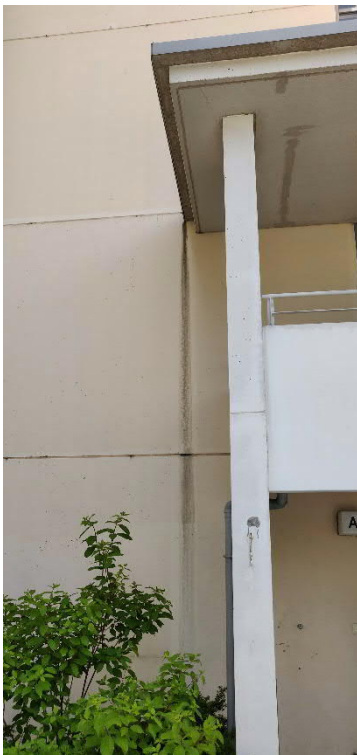
Kuva 19. Sisäänkäyntikatoksien vedenohjausta on suositeltavaa parantaa tulevien korjauksien yhteydessä.
