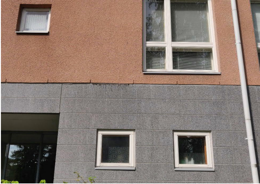
Kuva 8. Linnanrakentajantielle oleva julkisivupinta on rapattu. Rappauksessa ei todettu rapautumista koputtelun perusteella.
