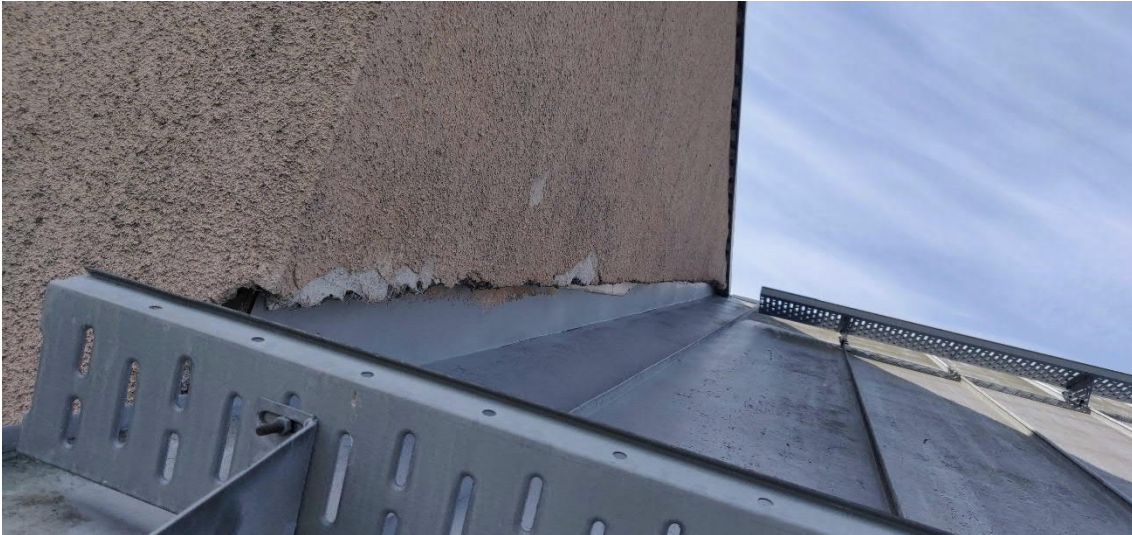
Kuva 2. Vesikatteen ja seinän ylösnoston liittymä ei ole tiivis. Sijainti Linnanrakentajantien ja Rouvienpolun kulmassa olevan porraskäytävän yläosassa.
