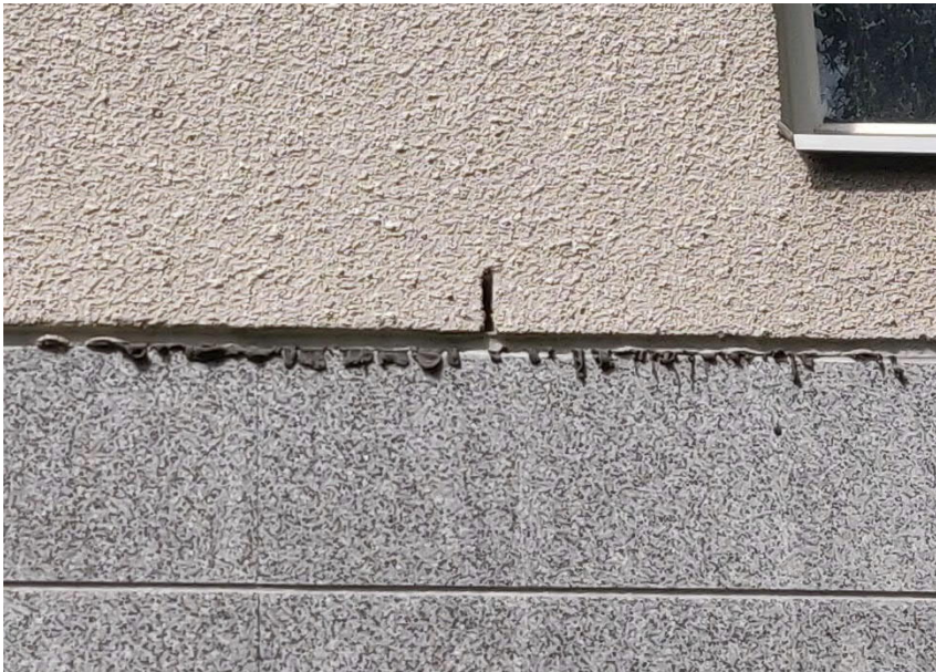
Kuva 9. Sokkelin ja rapatun julkisivun valumajälkiä
