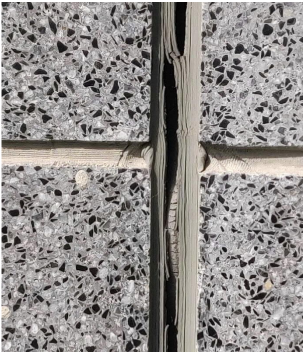
Kuva 6. Elastisissa elementtisaumoissa paljon halkeamia.
