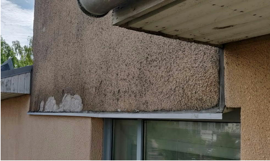
Kuva 1. Linnanrakentajantien ja Rouvienpolun kulmassa olevan porrastornin yläosan rappaus on irti alustastaan.
