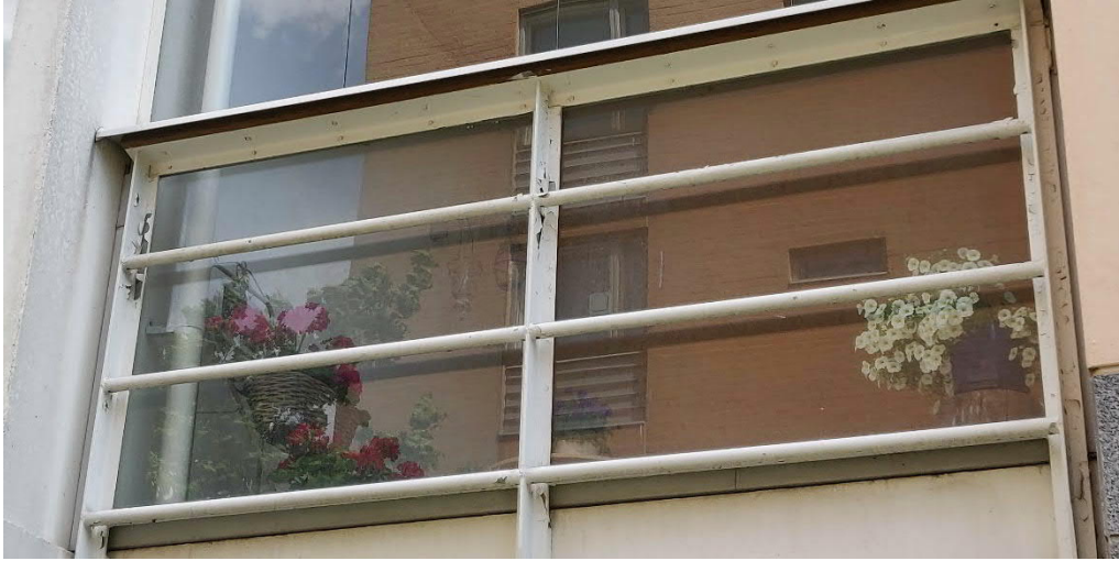
Kuva 13. Teräskaiteiden maalipinnat paikoittain irronneet alustastaan.
