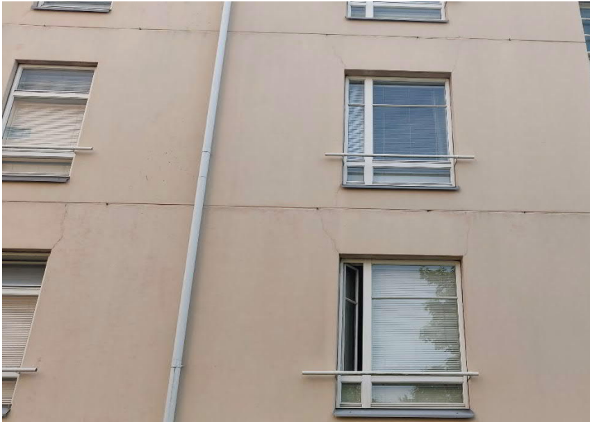
Kuva 3. Rouvienpolulle (luoteeseen) olevassa julkisivussa useita halkeamia julkisivuelementissä
