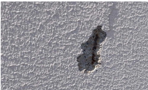
Kuva 4. Terästen korroosio on aiheuttanut betonin halkeilun. Kuvan kohta on yksittäinen vaurio. Yleisesti elementtien teräksien suojaokerospaksuus on riittävä.
