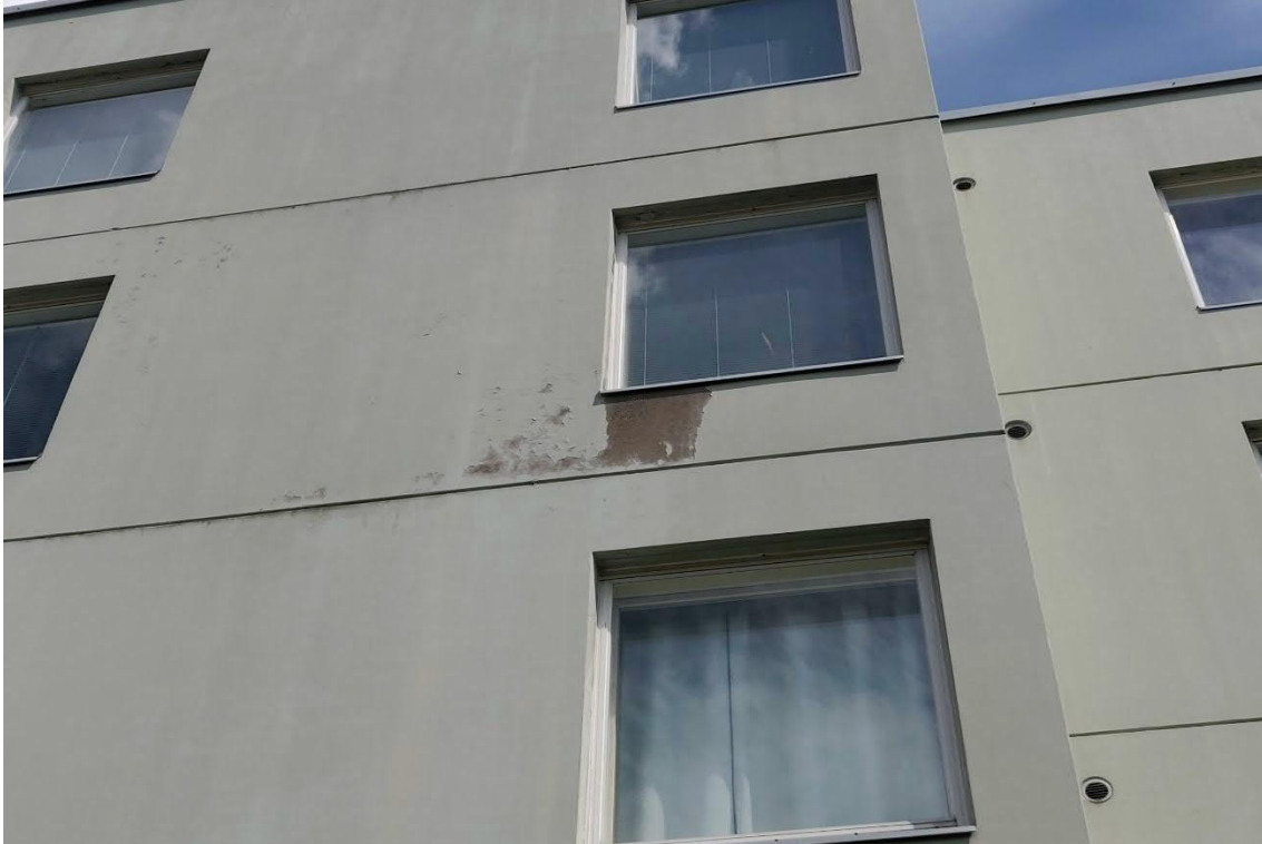
Kuva 18. Julkisivuissa havaittiin paikallisia maalipinnan vaurioita. Julkisivut suositellaan pestävän ja huoltomaalattavan lähitulevaisuudessa.
