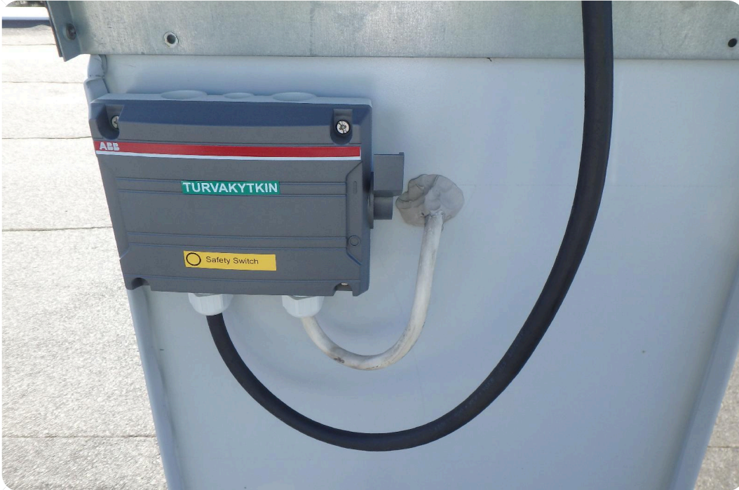
Havainto 2 Turvakytkimelle ei ole asennettu sadekatosta.
