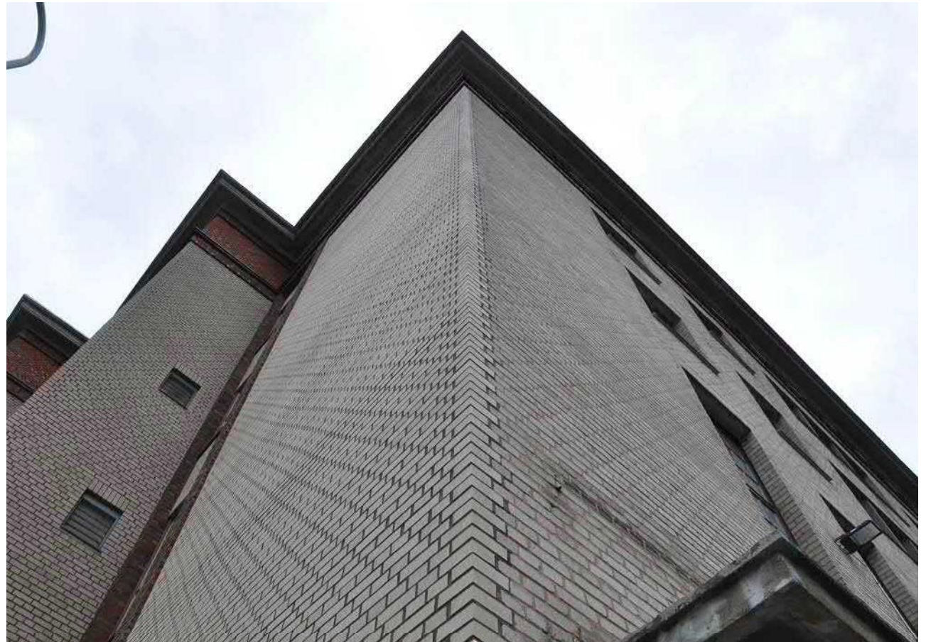
Tiilien ero on havaittavissa rakennuksen kulmassa. Kuva 2017.
