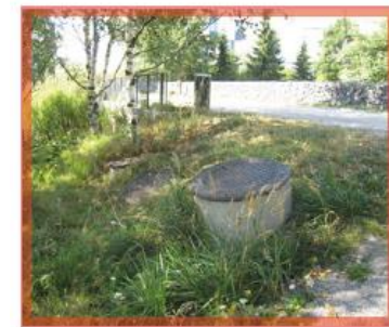
Maan painumisen seurauksena kaivot ovat kääntyneet vinoon.
