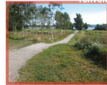
Rantaa kohti suuntautuvan käytävän profiilissa näkyy painuma.
