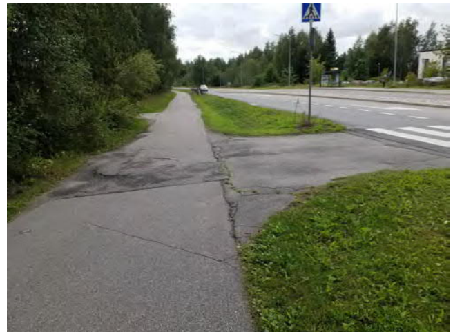
Kuva 87. Malminkaaren pintamateriaalivauriot kunnostetaan.
