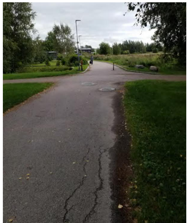
Kuva 84. Sammalpolun rakenteelliset vauriot ja pintamateriaalit kunnostetaan.
