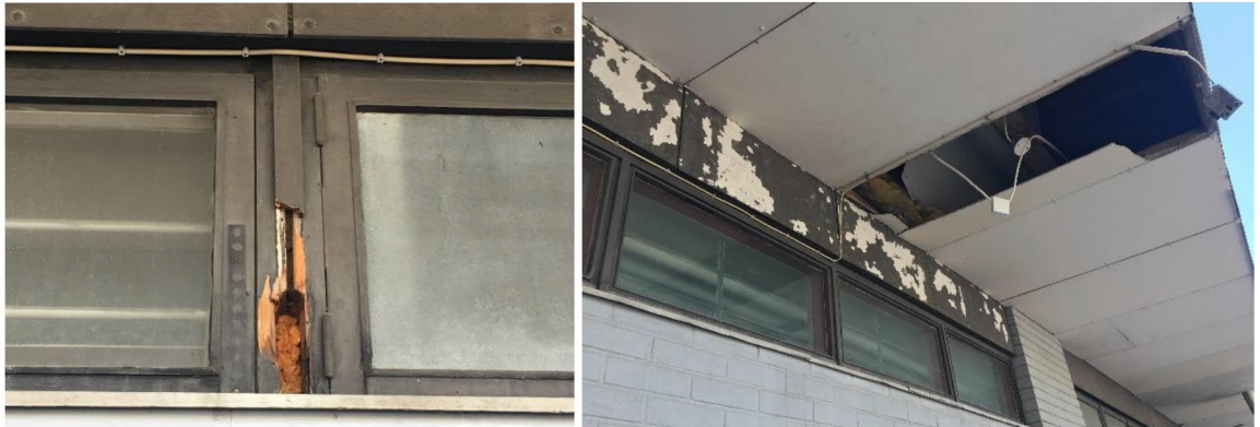
Rispaantuneet ikkunanpuitteet ja katto parkkipaikan puolella
