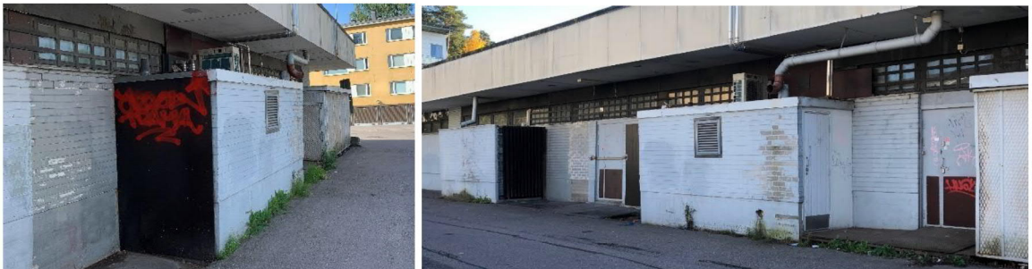
Parkkipaikan puoleiset Alepan yhteydessä olevat laatikkosuojat huonossa kunnossa
