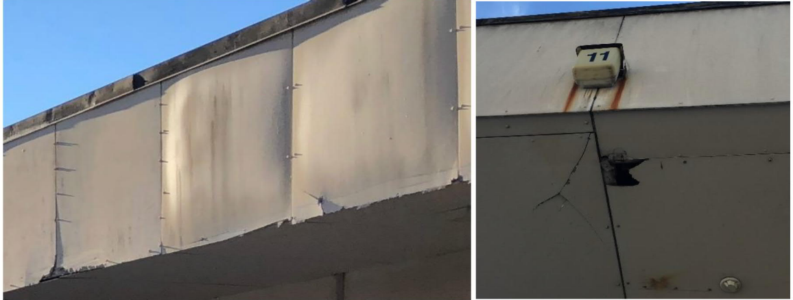
Tasakaton otsalistan alkuperäiset Minerit-levyt ovat kauttaaltaan vaurioituneita
