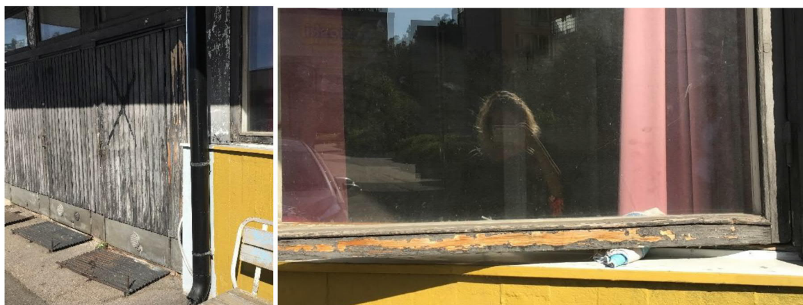
Lämpökeskuksen alkuperäiset ikkunat ja ovet kauttaaltaan lohkeilleet Kuvat: Arkkitehtitoimisto Petri Rouhiainen Oy / Leppänen Arkkitehdit Oy
