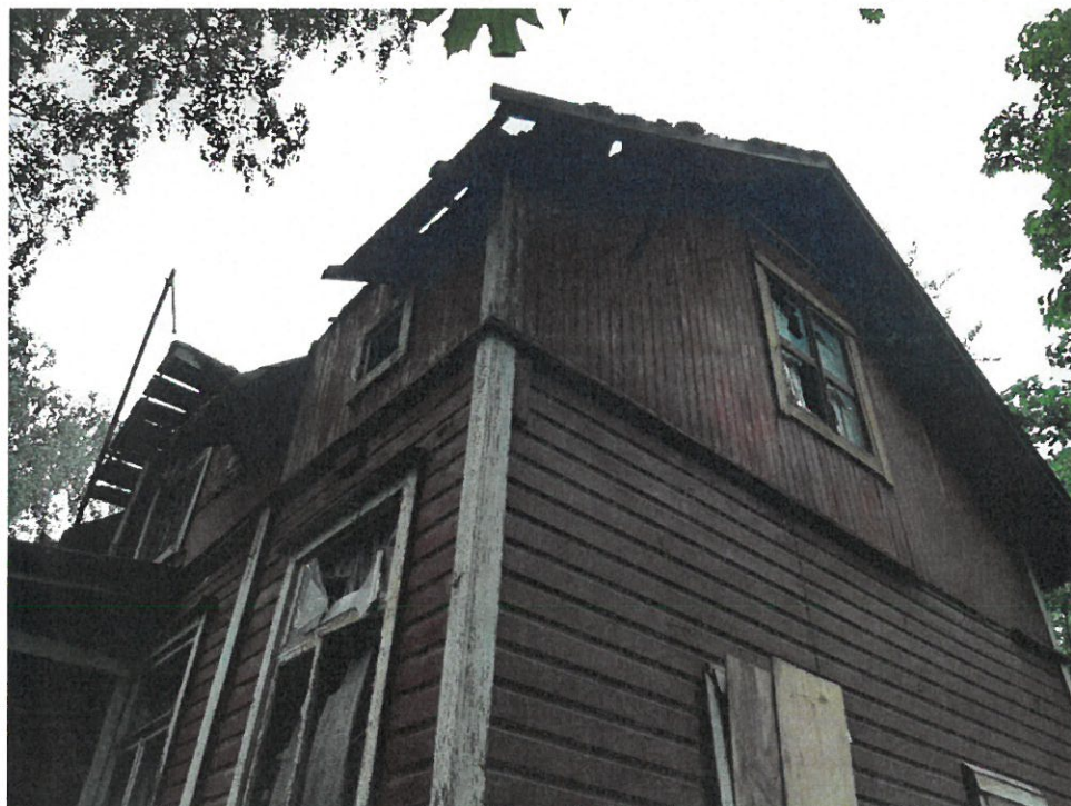
Kuva 11 Julkisivu koiliseen, vesikatto on romahtanut
