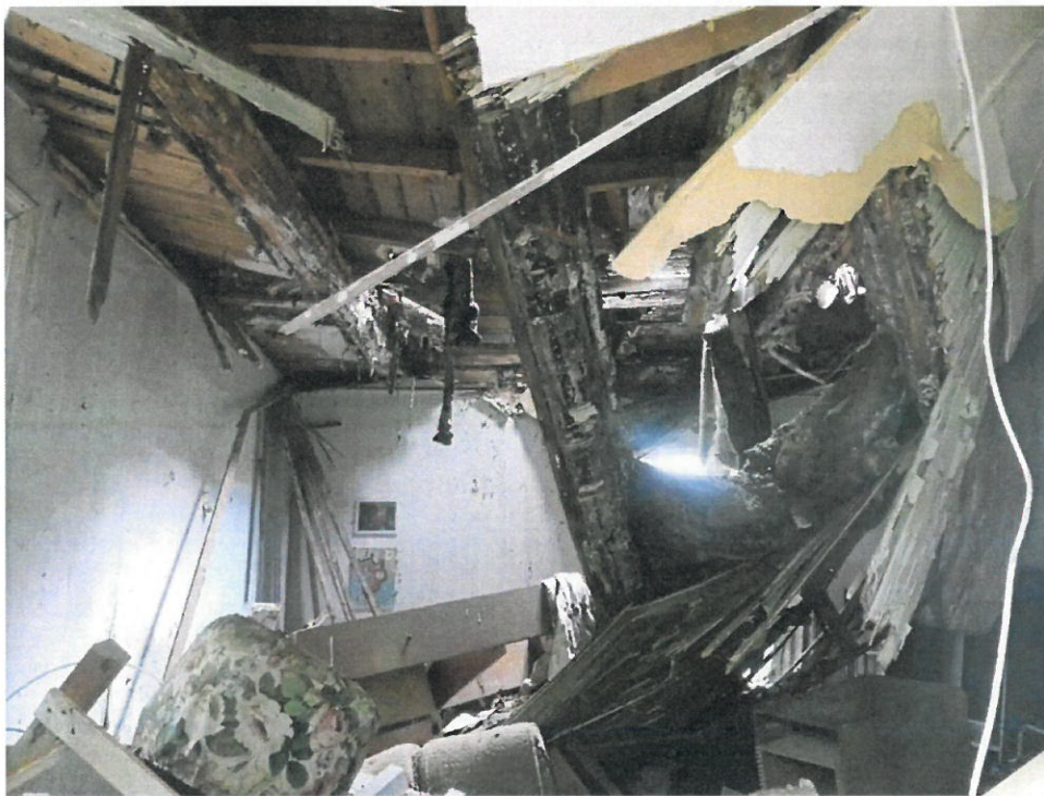
Kuva 13 Rakennuksen sisäpuoli, välipohjarakenne on romahtanut
