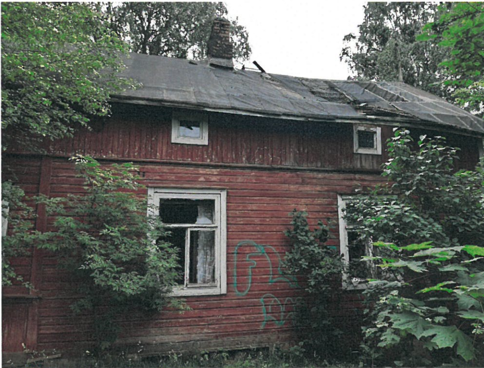
Kuva 12 Julkisivu luoteeseen, vesikatto on romahtanut
