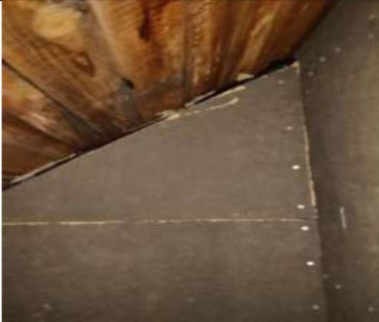
Lisähuoneen levytyksen ja kattorakenteiden välissä ei ole lainkaan tuuletusväliä.
