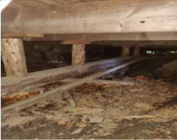
Kantavia hirsirakenteita. Orgaanista jätettä talon alla.
