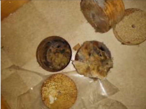
Kuva lattiarakenteesta. Lattiapuut, paperi ja levytys on jo hieman homeessa.
