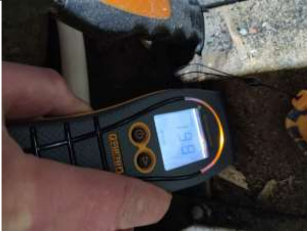
Kuva 11 piikkimittarilla mitattuna havaittiin kohonneita kosteusarvoja alalautoituksessa kylpyhuoneen vieressä.
