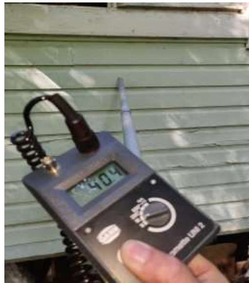
Ylempää seinä on kuiva
