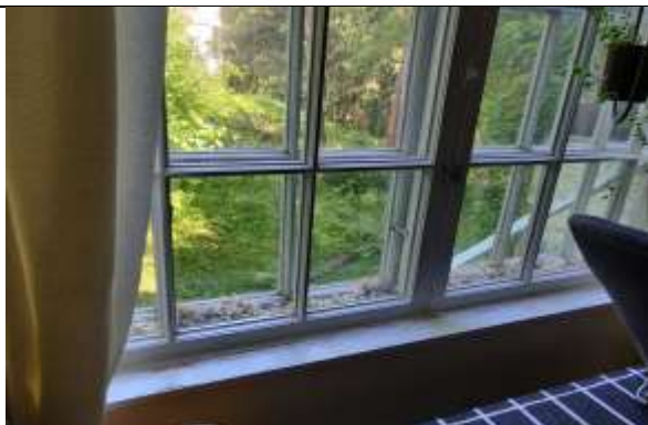
Ikkunapenkissä maali irtoillut
