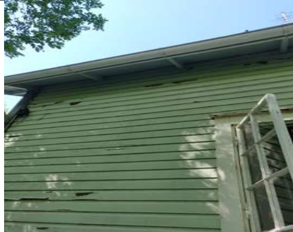
Maali halkeilee seinästä.
