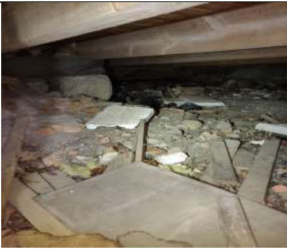
Rakennusjätettä talon alla.
