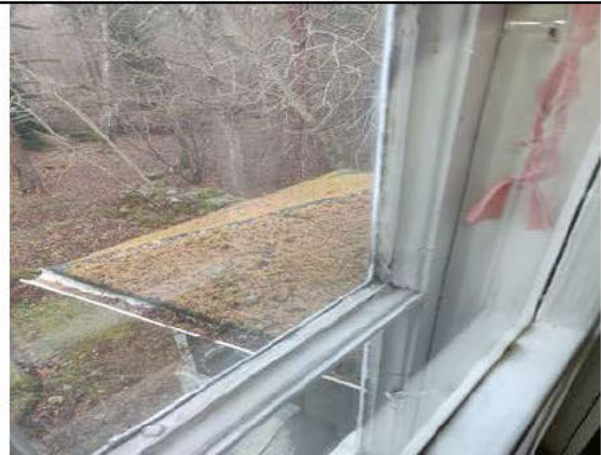
Kuva 22 katolla ja vesikouruissa likaa.
