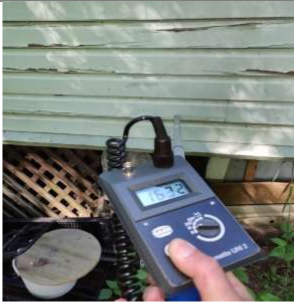
Kohdassa, jossa sisätilassa on ollut vesivahinko, on seinän kosteusarvot koholla.
