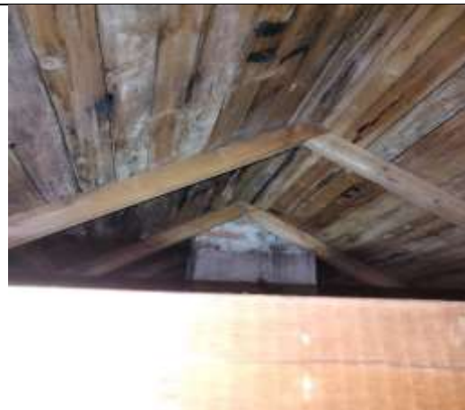
Kattoristikko ja aluslaudoitus. Aluslaudoituksessa vanhoja kosteusjälkiä.
