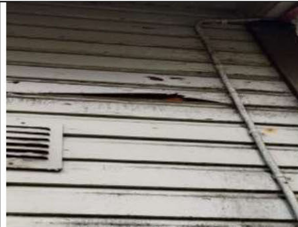
Kuva 19 maalipinta irtoilee seinästä.
