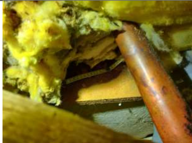
Kuva 4 lattian alla putkiläpivientien kohdalla puuttuu alusrakenne kokonaan.
