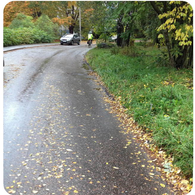
Kuva 64. Laaja reunapainuma, jossa pahimmissa kohdassa rakenteet ovat pettäneet. Asfaltti on levinnyt painuman yhteydessä asfalttimakkaran päälle viheralueen reunassa.
