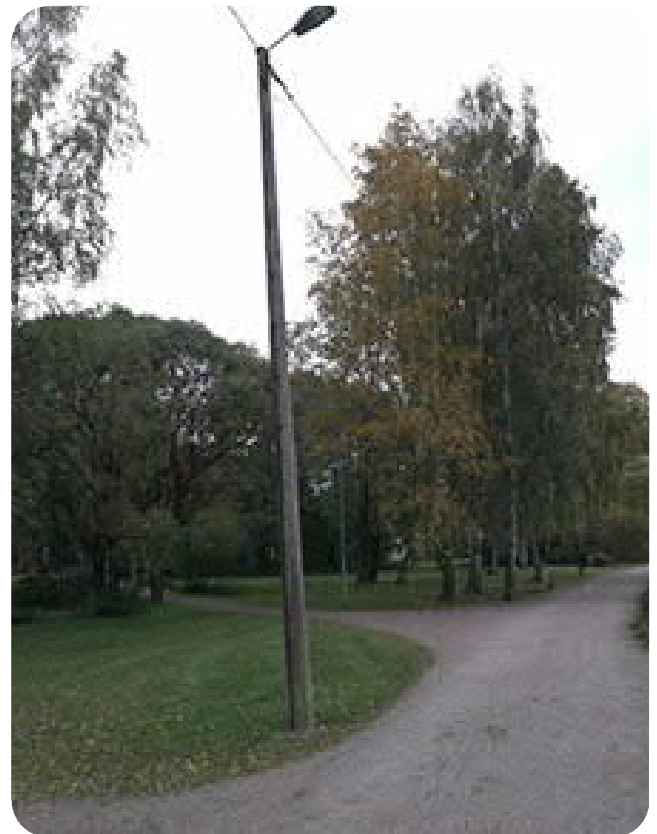
Kuva 71. Valaistus on uusimisen tarpeessa.
