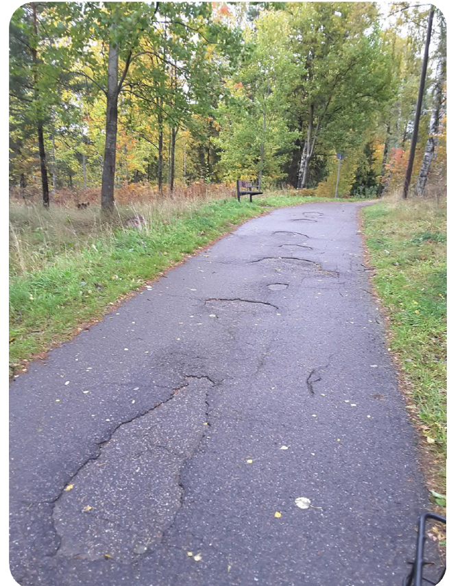
Kuva 75. Roihuvuorenseläitillä puiden juuret rikkovat päällysteen ja ohut päällyste purkautuu routimisesta ja talvikunnossapidosta johtuen.
