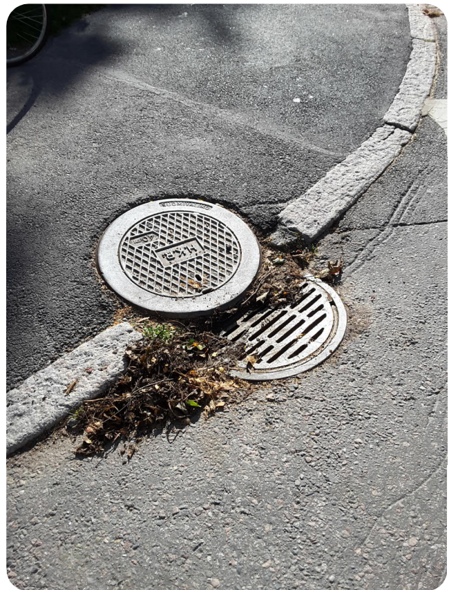
Kuva 46. ”Limputettuja” sadevesikaivoja Susitiellä.
