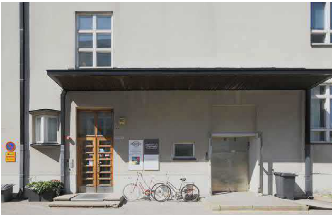
Pääsisäänkäynnin ja tavarahissin katos itäjulkisivulla. Julkisivussa on erkeri-ikkuna pääsisäänkäynnin vieressä. Tavarahissin edustalla ollut lastauslava purettiin 1965. Nyt siinä on betonikoroke.
