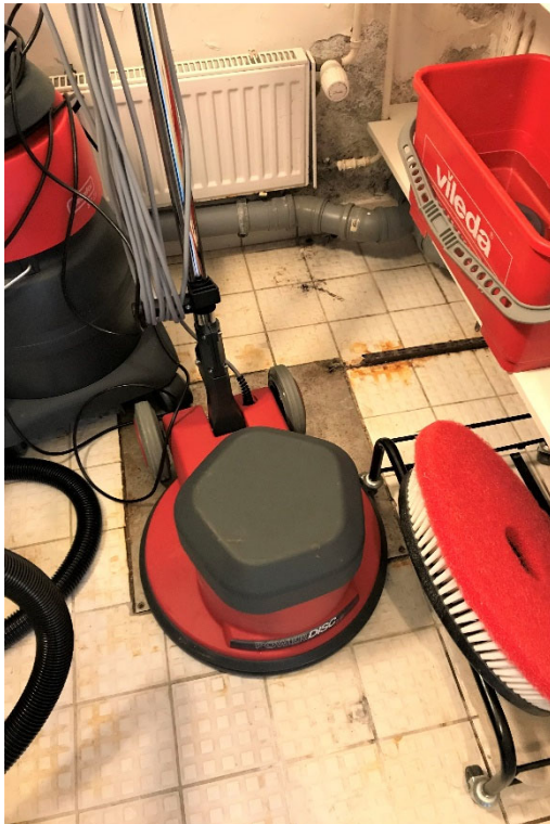
Kuva 17. Siivoustila, jossa on huonokuntoisia pintoja ja välineiden säilyttämistä lattialla. LK.
