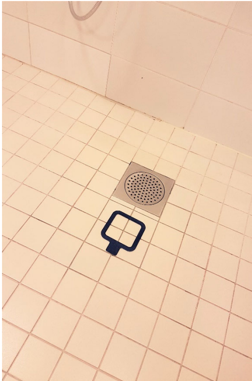
Kuva 11. Pesutilan lattiakaivon läheisyys todettiin puhtaanapidon kriittisimmäksi pisteeksi. AH.
