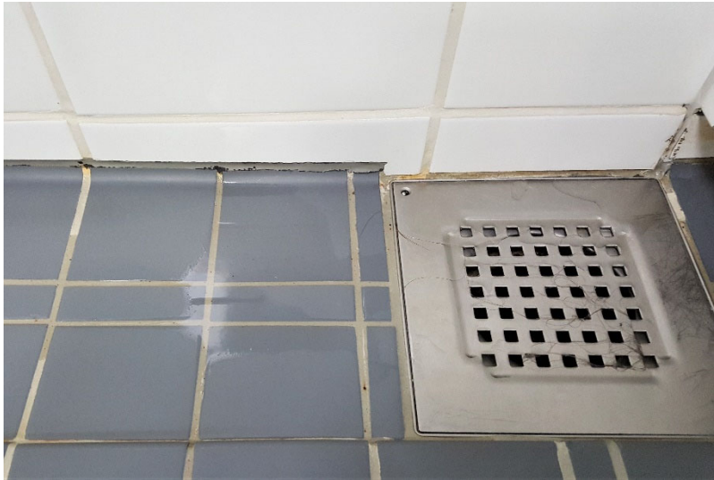
Kuva 22. Likainen lattiakaivo, jonka kansi kiinnitetty ruuveilla. SF.
