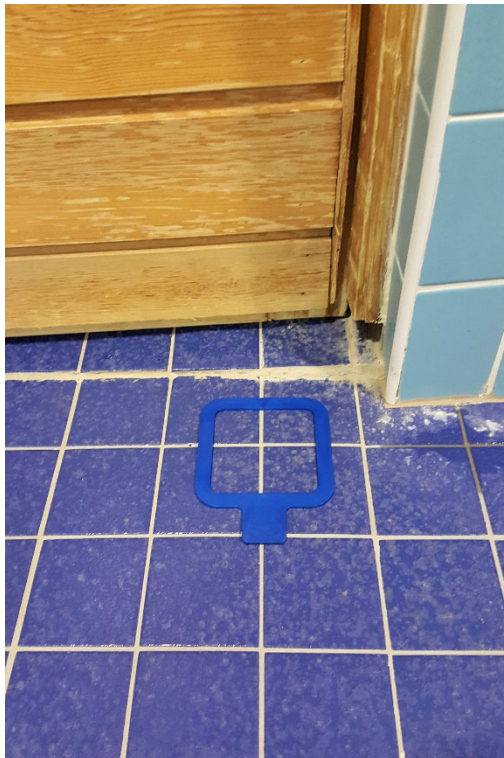
Kuva 13. Kulumaa ovessa ja kalkkisaostuma lattiassa. Kuva Sari Front.
