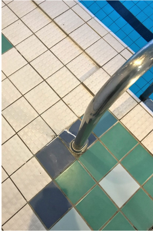
Kuva 15. Rikkinäistä ja kulunutta pintaa allastiloissa. LK.
