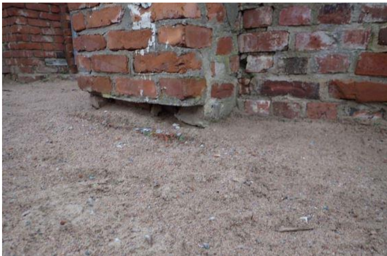
Kuva 6 Tiiliä puuttuu ja vaurioituminen on laajaa etenkin muurin alaosassa.
