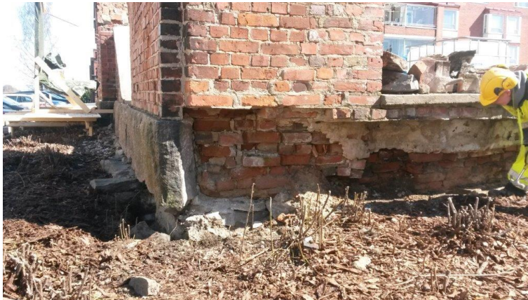
Kuva 3 Sokkelin korjaus ja rapautuneita tiiliä.
