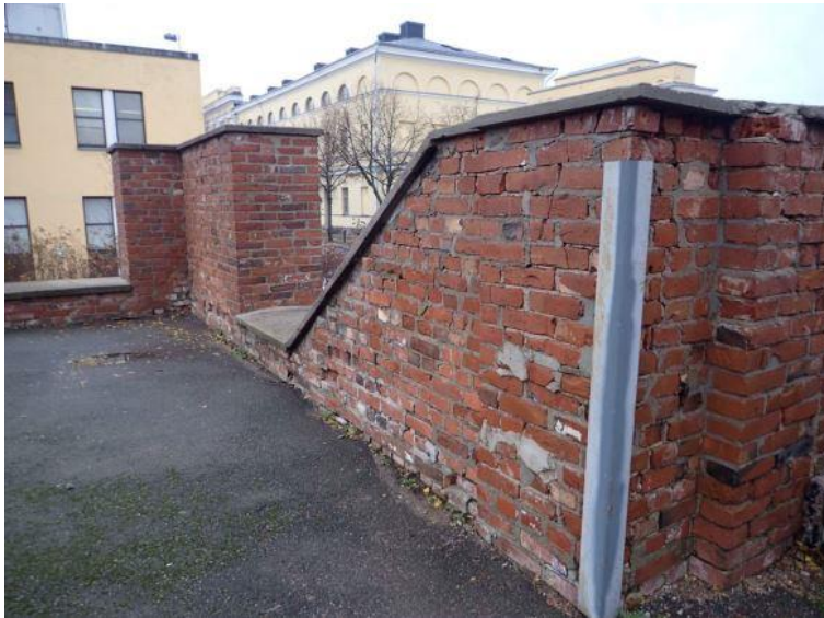
Kuva 5 Rapautunutta muuria on vahvistettu kulmarauhoilla.
