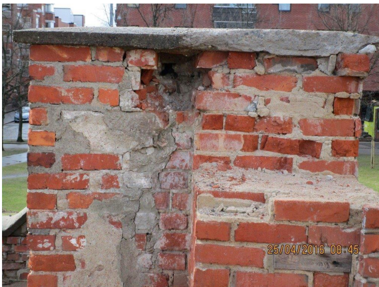
Kuva 4 Vaurioita korjattiin viimeksi 2 v. sitten. Muurien vaurioituminen on jatkunut korjauksien jälkeen ja jatkuu edelleen.
