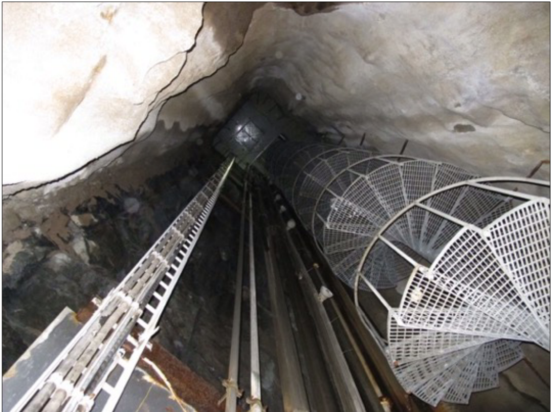
Liite 5 – Hätäpoistumiskuiluni kierreportaat. 27 metriä syvä kuilu oli lepakoiden kannalta sopiva, mutta havaintoja ei tehty.
